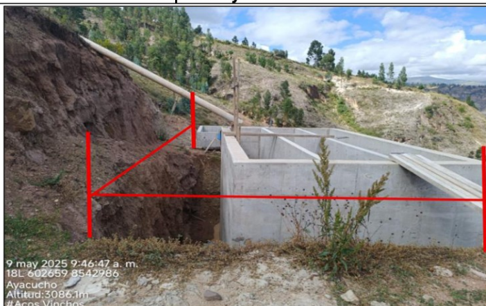
Vista n.º 1. Se muestra planta de tratamiento de aguas servidas, no cuenta con señalización de seguridad ante riesgo de caídas a distinto nivel, desplomes o derrumbes.
