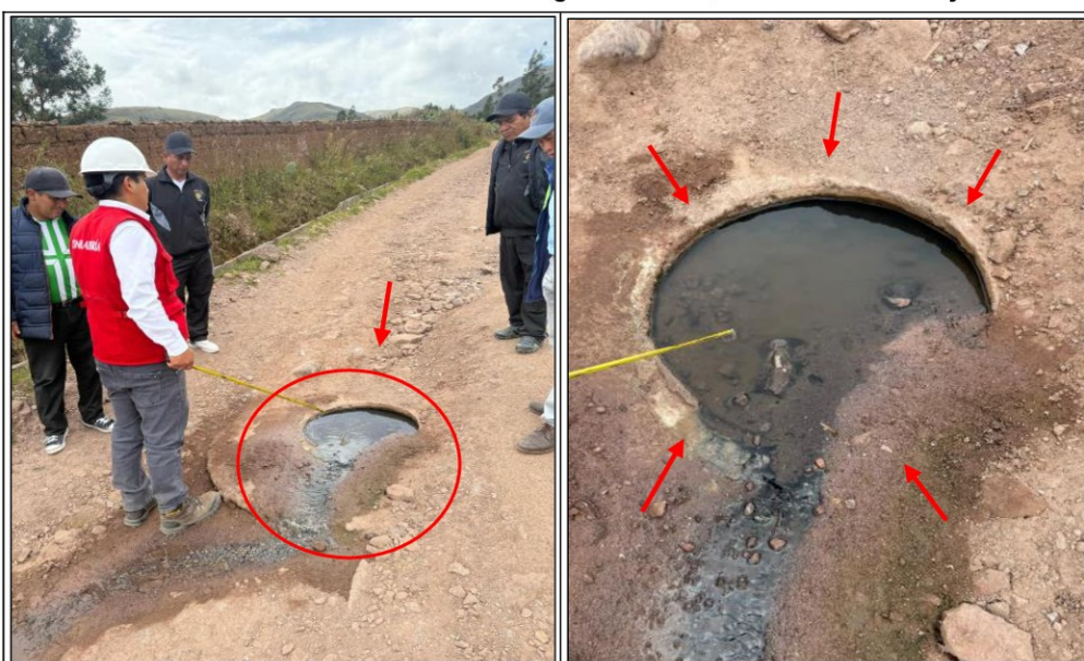
Vista n.º 1. Se muestra un (1) buzón con estancamiento de aguas servidas, entre el centro poblado de Huaychao y Capillapata.
