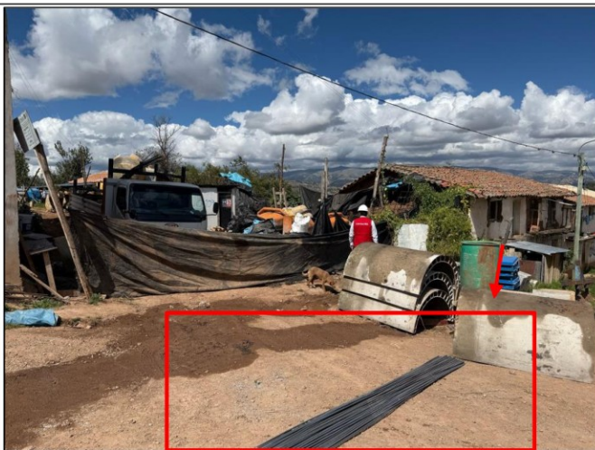
Vista n.º 1. Se muestra deficiente almacenamiento del acero en las instalaciones del almacén de obra, en contacto directo con el suelo.
