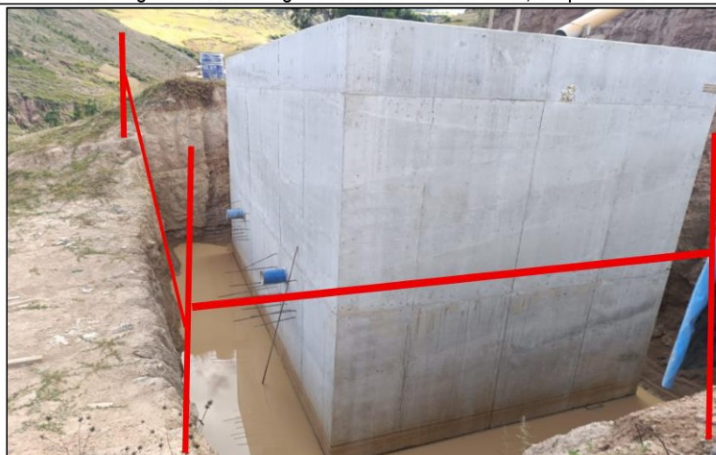
Vista n.º 2. Se muestra planta de tratamiento de aguas servidas, no cuenta con señalización de seguridad ante riesgo de caídas a distinto nivel, desplomes o derrumbes.
