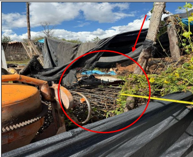
Vista n.º 2. Se muestra acero habilitado para buzones, sin protección y en proceso de corrosión.
