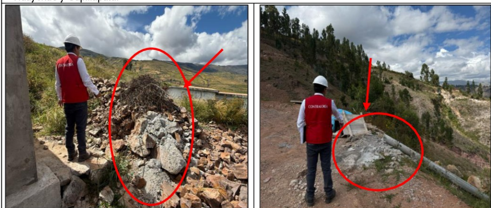
Vista n.º 2. Se muestra falta de eliminación de residuos /desechos metálicos y concreto, en la progresiva km 3+301.84 "reservorio de 20 m 3 ", de la línea de conducción.
