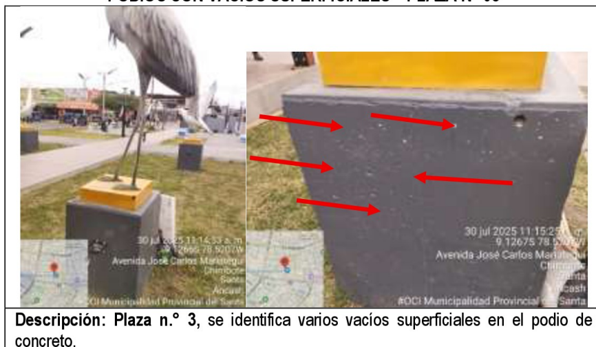
IMÁGENES N°s 18 Y 19 PODIOS CON VACÍOS SUPERFICIALES – PLAZA N° 03
