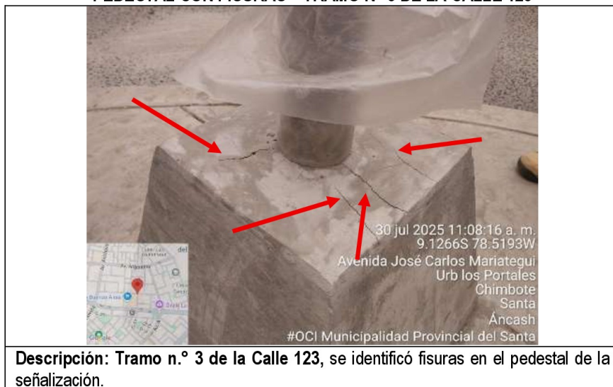
IMAGEN N° 17 PEDESTAL CON FISURAS – TRAMO N° 3 DE LA CALLE 123
