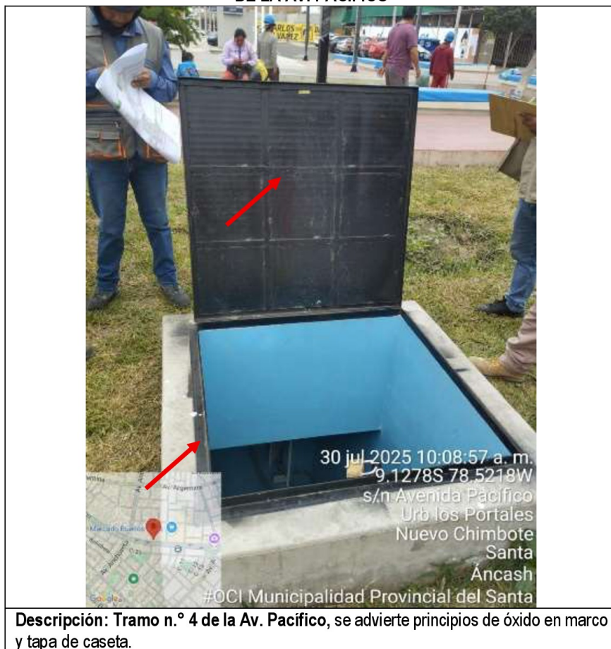
IMAGEN N° 27 MARCO Y TAPA DE CASETA DE SISTEMA DE RIEGO CON ÓXIDO – TRAMO N° 04 DE LA AV. PACÍFICO
