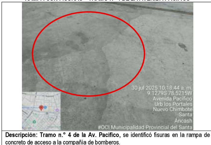
IMAGEN N° 13 RAMPA CON FISURAS – TRAMO N° 4 DE LA AVENIDA PACÍFICO
