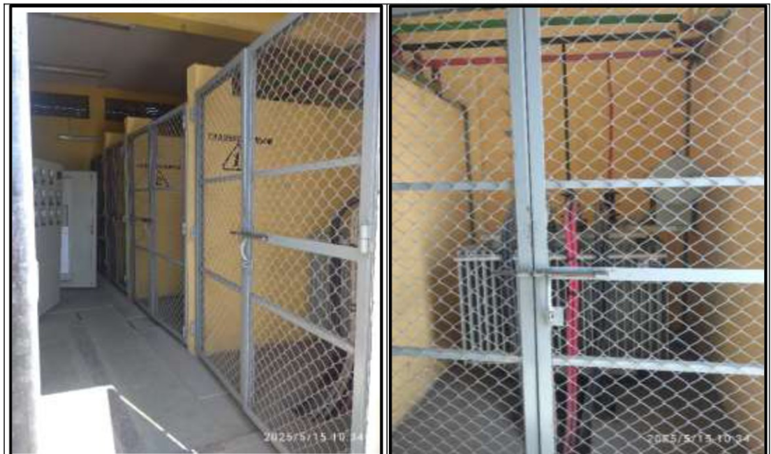
SUBESTACIÓN ELÉCTRICA CON TRANSFORMADORES Y TABLEROS
