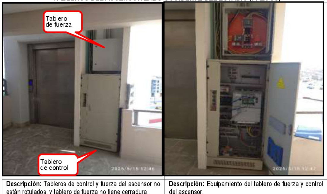
FOTOGRAFÍAS N°s 20 y 21 TABLEROS DEL ASCENSOR LADO OCCIDENTE DEL ESTADIO (PALCOS)
