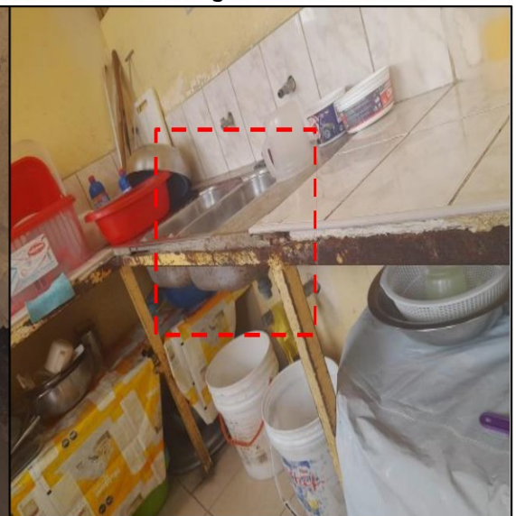
No cuenta con desagüe en los lavaderos
