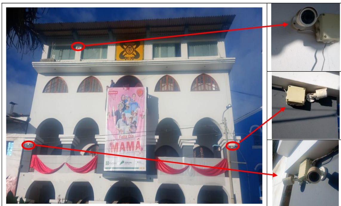
IMAGEN N° 1 CÁMARAS DE VIDEOVIGILANCIA INSTALADAS EN EL FRONTIS DEL EDIFICIO MUNICIPAL
