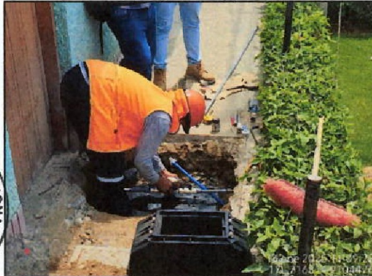
Fuente: Acta de inspección física de 13 de enero de 2025. Elaborado por: Comisión de control.
