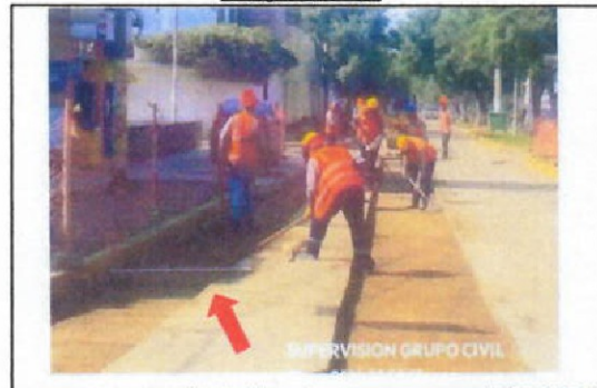
Foto N°06 se aprecia la realización del berrido y limpieza para realizar la imprimación en la Av. Teodoro Valcárcel.
