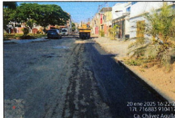
Fuente: Acta de inspección física n.º 01-2024-HC10-CUI2115955 de 20 de enero de 2025. Elaborado por: Comisión de control.
