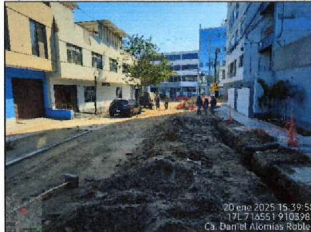
Fuente: Acta de inspección física n.º 01-2024-HC10-CUI2115955 de 20 de enero de 2025. Elaborado por: Comisión de control.
