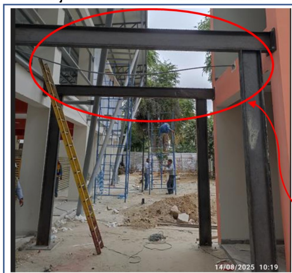
Imagen n.º 7 Trabajos inconclusos en la Losa Colaborante
