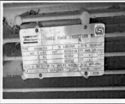
Imagen 4: Placa de datos motor eléctricos Atlas Copco de compresor de aire de 75kW de potencia y 50Hz de frecuencia.
