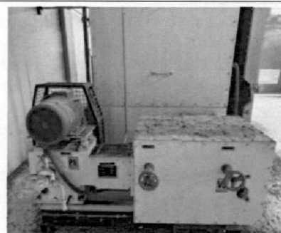
Imagen 13: Bomba de oxígeno líquido.
