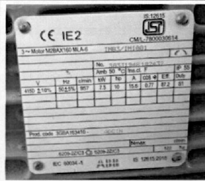
Imagen 12: Placa de datos motor eléctrico de la marca ABB de expansor criogénico de 7.5kW de potencia y 50Hz +/- 5% de frecuencia.
