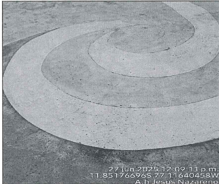
Imagen n.º 45 Fisuras en la figura de la ballena
