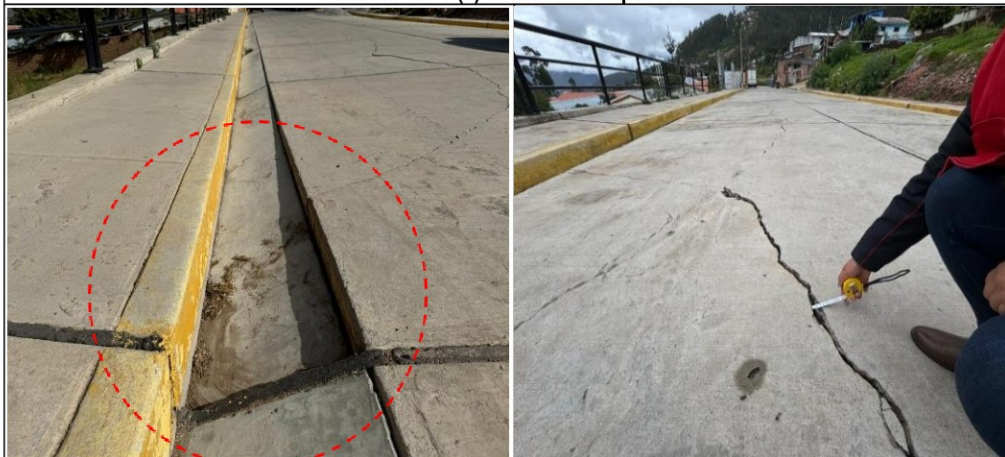
Imagen 4: Se observa el asentamiento de un tramo de la cuneta en 10 cm aproximadamente.
