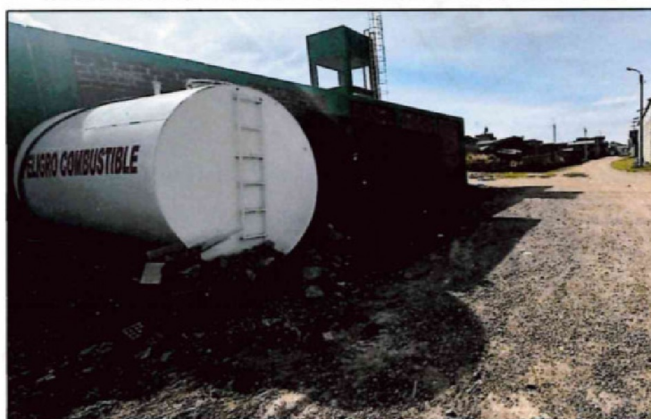
IMAGEN N° 2 TANQUE CISTERNA PARA ALMACENAMIENTO DE COMBUSTIBLE
