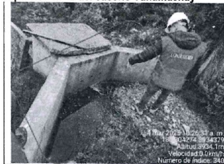
Fotografía n.° 10. Vista que muestra, la cámara húmeda se evidencia 6 llorones de los cuales 3 son adicionales que se realizaron por la no presencia de agua en épocas de verano. Se evidencia que no soluciona el problema en verano. También se evidencia la estructura de la captación del ojo de agua a la interperie sin protección y resguardo de buena agua para consumo con algas y hongos. La población está consumiendo el agua contaminada.
