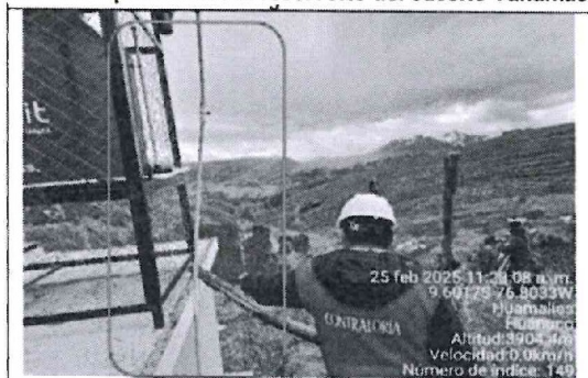
Fotografía n.° 27.- Vista que muestra, la no instalación del sistema de agua para el tanque de cloración sin sujetadores, además se encuentra desprendidas.
