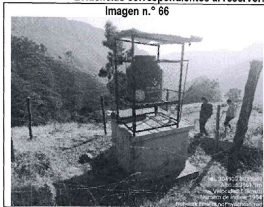
Fotografía n.° 66.- Vista que muestra, el reservorio construido y cuya estructura metálica de la caseta de cloración no se encuentra ubicada correctamente, lo que hace que para de inspección del reservorio no se pueda abrir correctamente.
