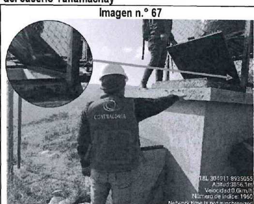
Fotografía n.° 67.- Vista que muestra, que la puerta de ingreso al reservorio, no se encuentra libre, ya que tiene como tope al ángulo de la estructura del sistema de cloración, esto dificulta a la revisión del interior del reservorio.
