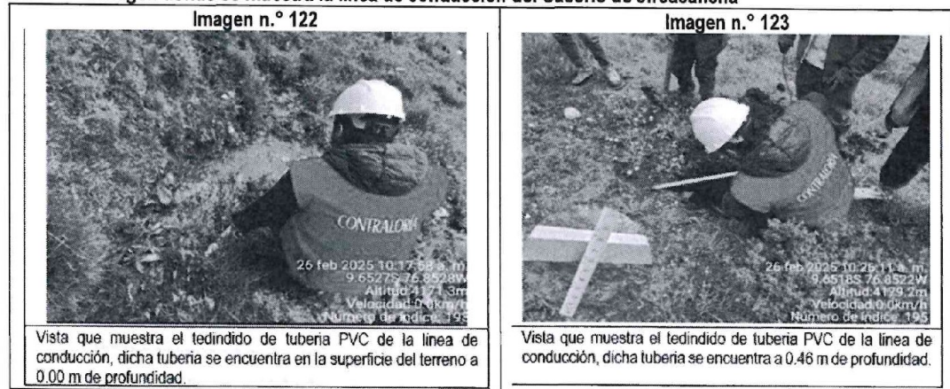
Imagen n.° 122 y 123 Imagen donde se muestra la línea de conducción del Caserío de Jircacancha
