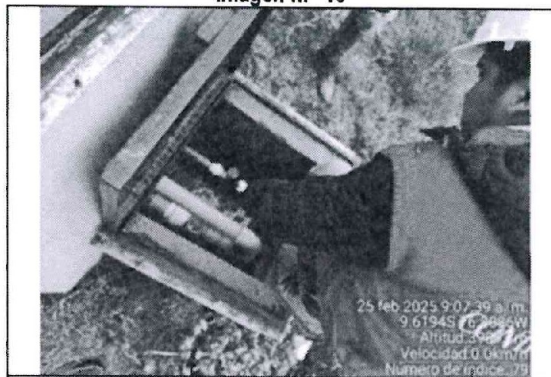
Fotografía n.º 1.- Vista que muestra la presencia de agua en la caja de válvulas, se evidencia fuga de agua.
