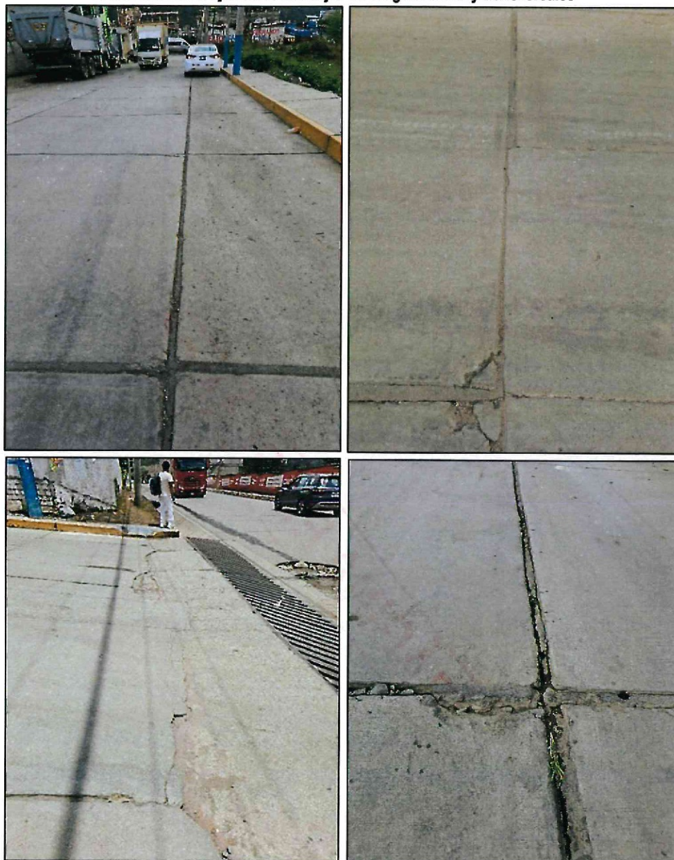
Imágenes n.º 9, 10, 11 y 12 Deficiencia en la ejecución de las juntas longitudinales y transversales
