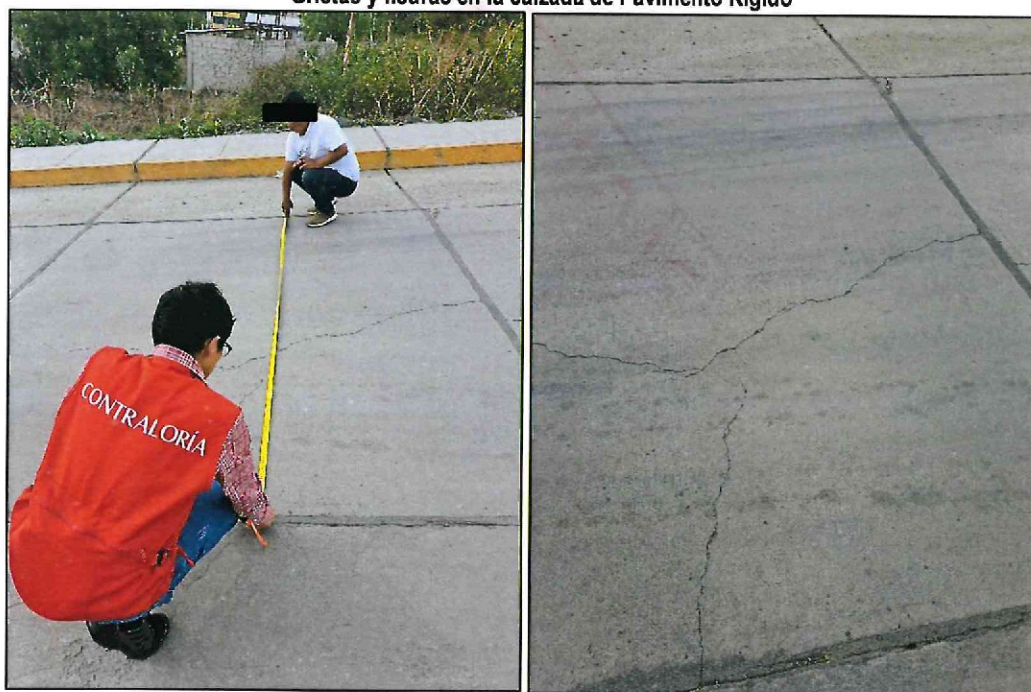
Imágenes n.º 3, 4, 5 y 6 Grietas y fisuras en la calzada de Pavimento Rígido
