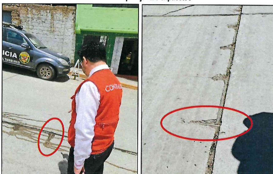
Imágenes n.º 15 y 16 Dowels o pasajuntas expuestos
