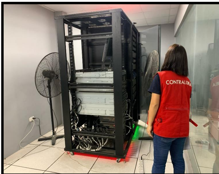
Imagen n.º 12 Inadecuado sistema inadecua para el sistema de almacenaje de datos.
