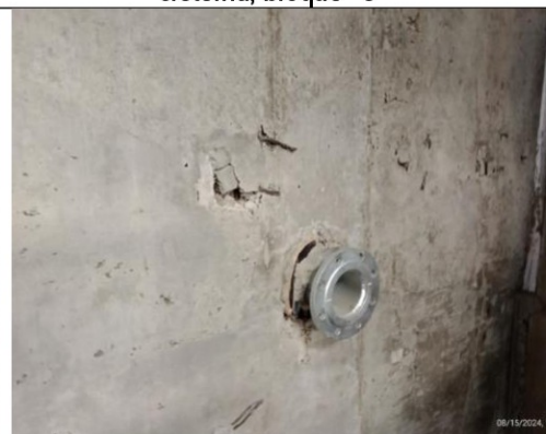
Imagen n.º 8 Cangrejas en la placa del eje 2" del tanque cisterna, bloque "C"
