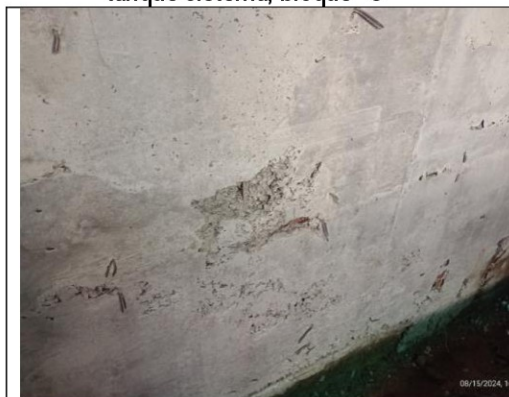
Imagen n.º 7 Cangrejas en la placa del eje 2" del tanque cisterna, bloque "C"
