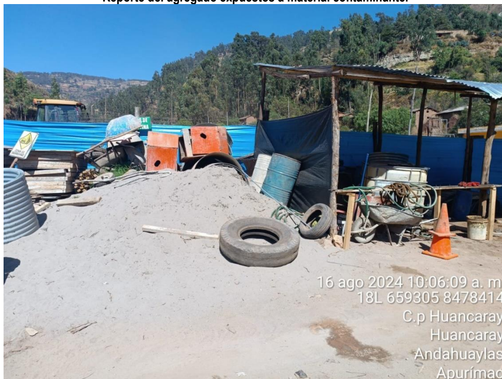
Imagen n.º 7 Reporte del agregado expuestos a material contaminante.
