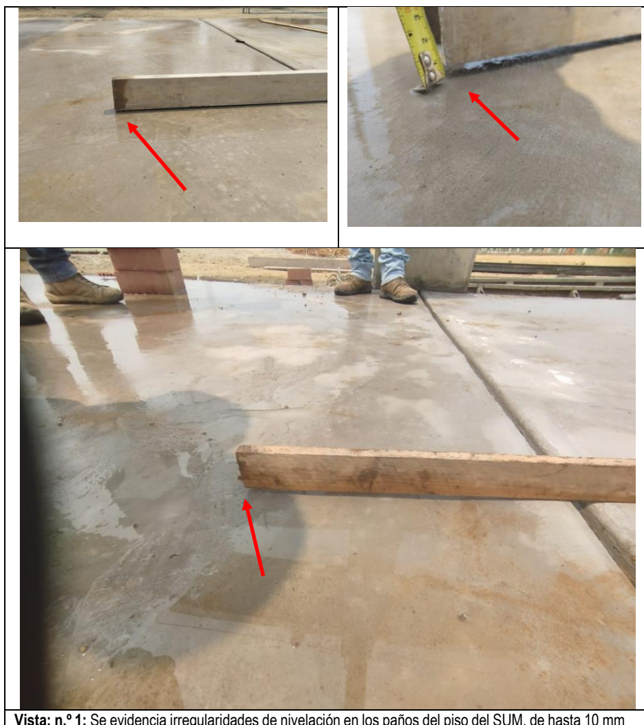
Imagen n.º 10 Irregularidad de nivelación
