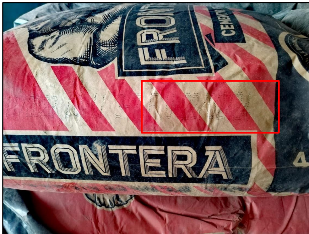
Imagen n.º 4 Bolsas de cemento vencidas, almacenadas en obra
