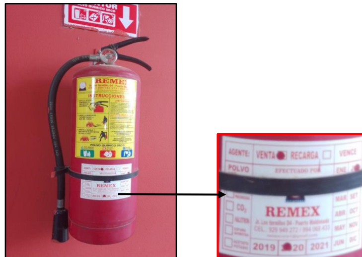
Imagen n.º 3 Extintor en la IE
