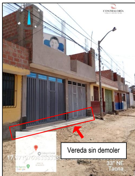
Imagen n.º 5 Predio ubicado en la Mz. C Lt. 22 entre la calle Juli y calle 98
