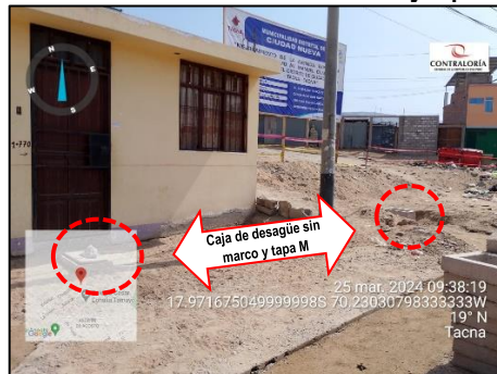
Imagen n.° 15 Conexión domiciliaria sin marco y tapa
