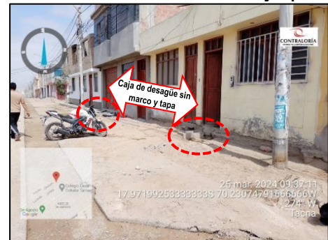
Imagen n.° 16 Conexión domiciliaria sin marco y tapa
