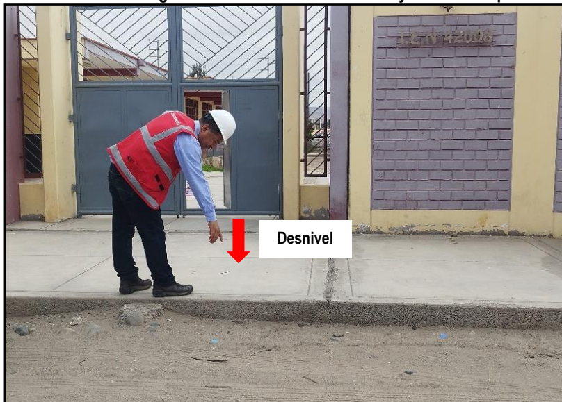
Imagen n.º 2 Desnivel al ingreso de la institución educativa y falta de rampa
