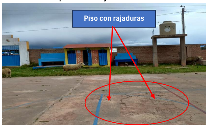
Imagen n.º 15 Losa Deportiva con Rajaduras – IIEE n.º 72557
