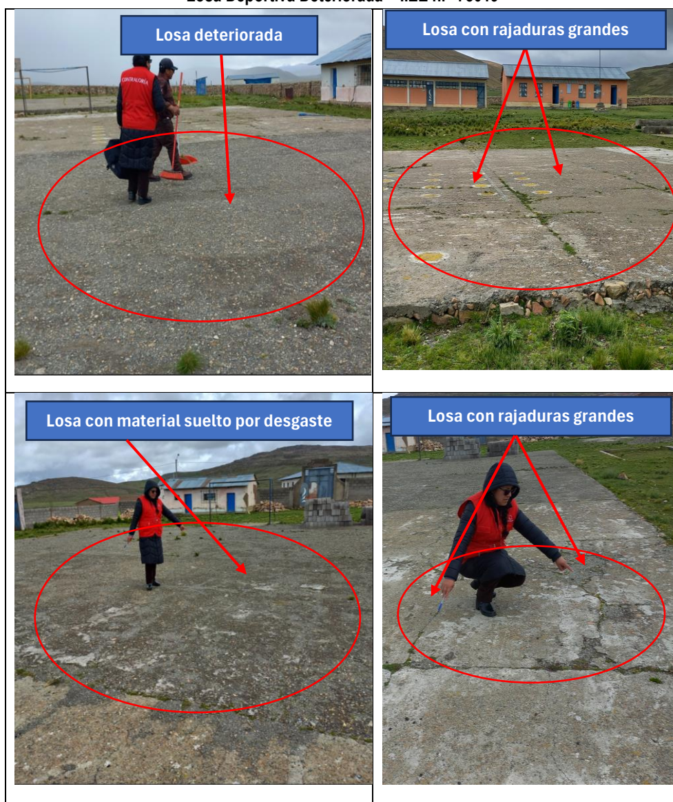
Imagen n.º 9 Losa Deportiva Deteriorada – IIEE n.º 73019
