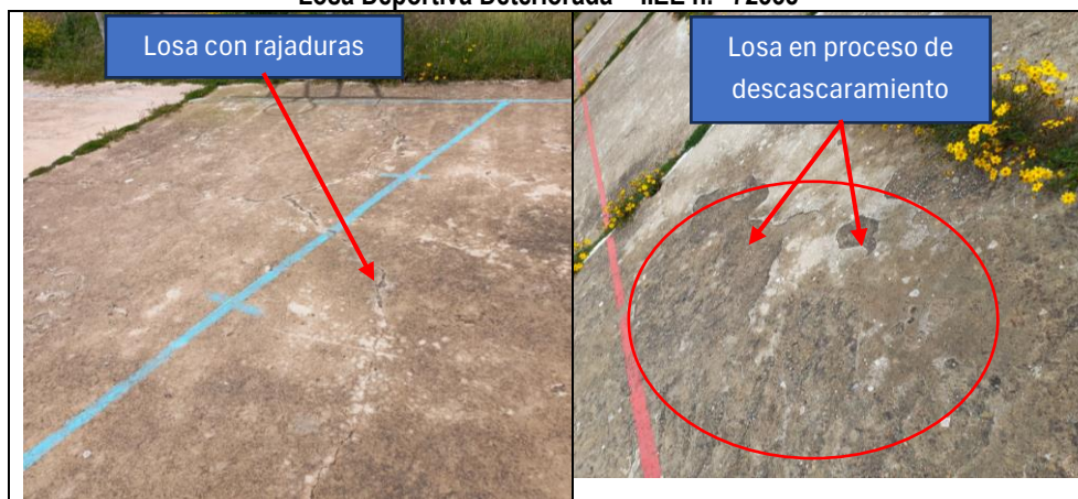
Imagen n.º 10 Losa Deportiva Deteriorada – IIEE n.º 72338
