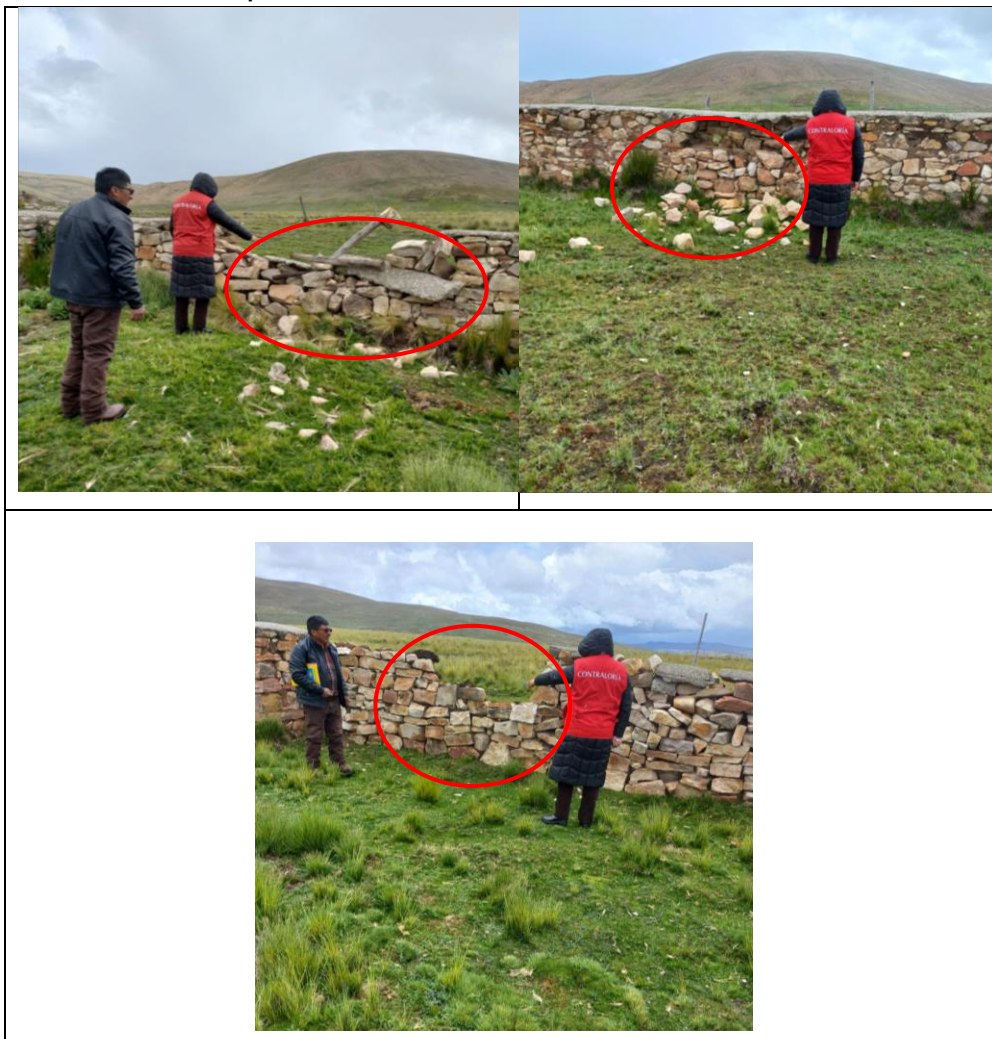
Imagen n.º 8 Desprendimiento de Cerco Perimétrico – IIEE n.º 73019
