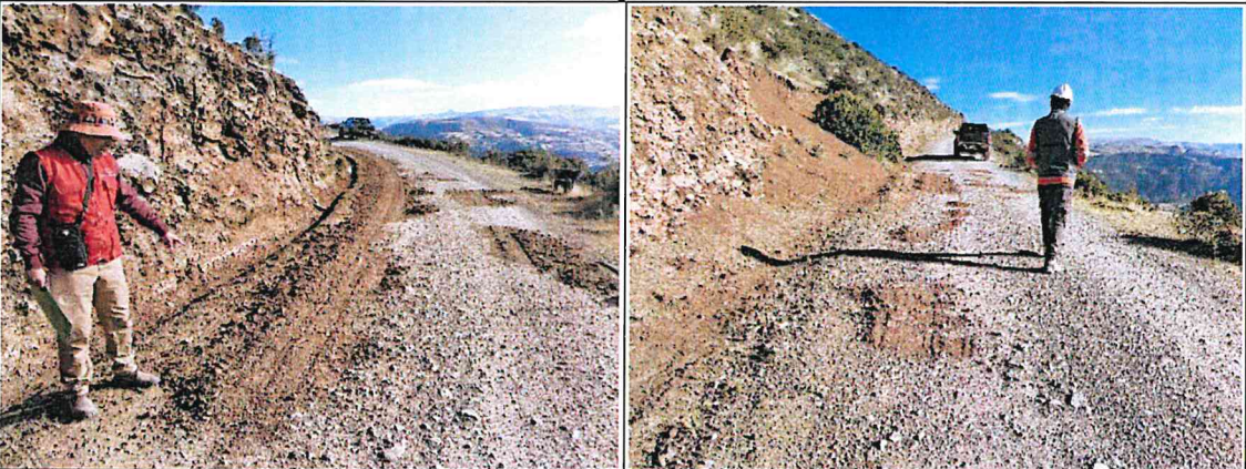
Imagen n.º 11: Progresiva km 7+250 – km 7+300 en la que la actividad de bacheo se viene realizando con material proveniente de la limpieza de cuneta, no siendo el material óptimo para la actividad citada.
