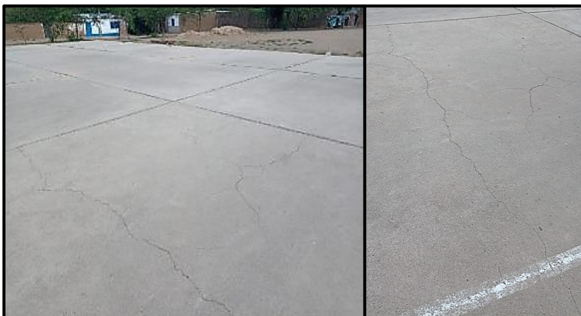
Imágenes n.ºs 9 y 10 Paños de concreto en losa deportiva
