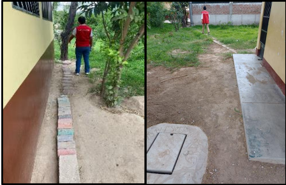
Imagen n.ºs 14 y 15 Ruta de acceso a Servicios higiénicos y losa deportiva presenta desniveles
