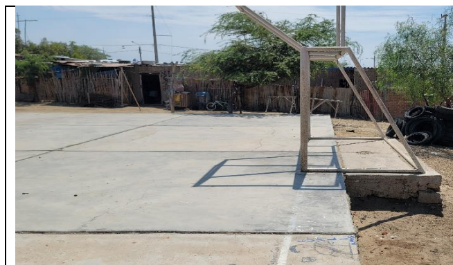
Imagen n.° 2 Losa deportiva requiere mantenimiento y/o sustitución de los paños.
