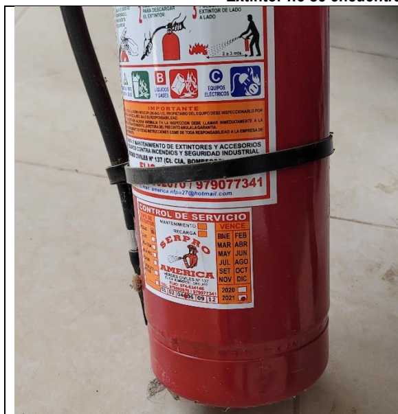
Imagen n.º 5 Extintor no se encuentra con fecha vigente
