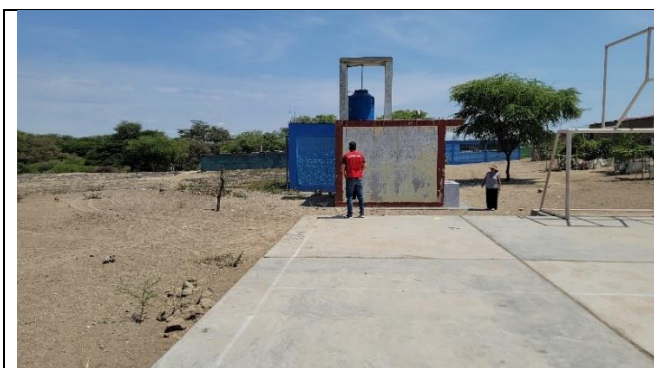
Imagen n.° 1 Inexistencia de cerco perimétrico
