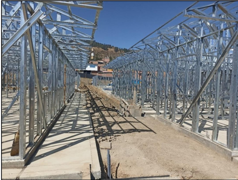
FOTOGRAFÍA N° 2 VERIFICACIÓN DE LA FALTA DE INSTALACIÓN DE DRYWALL
