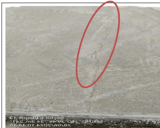
Fotografía n.º 3: Presencia de fisuras en bases de concreto de bancos de maquinarias.
