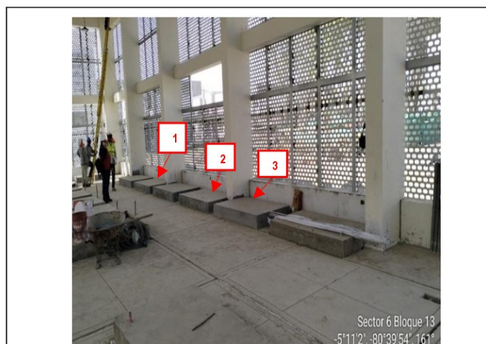
Fotografía n.º 10.- Se observan los bancos 1, 2 y 3 que interceptan la columna C-4.
