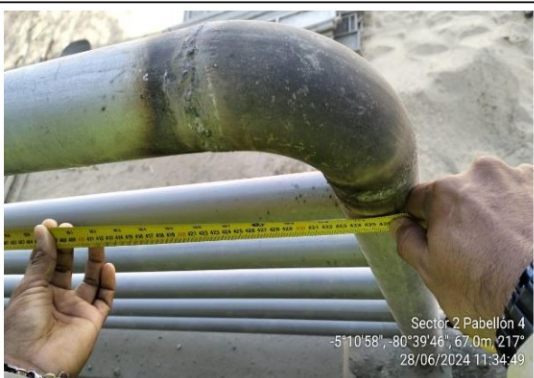
Fotografía n.º 20: Medición de longitud de tramo de baranda que no cuenta con soportes verticales intermedios.
