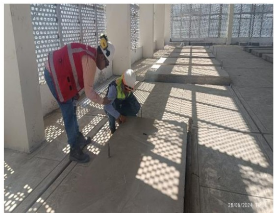
Fotografía n.º 4: Verificación de fisuras en bases de concreto de bancos de maquinarias.
