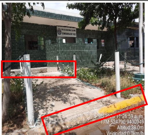
Fotografía n.° 3: Se aprecia el ingreso a la Comisaría el cual presenta desnivel.
