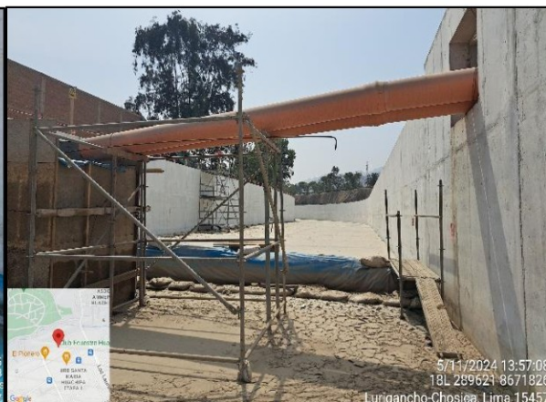
Foto N° 8: Vertimientos ubicados en la progresiva 2+950 (paquete 4.1B), según señala el Contratista pertenecen a la empresa Campo Fe y a la Junta de Regantes.
