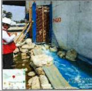
Foto 8: Vertimiento localizado en la progresiva 3+800 (paquete 4.1B), según señala el Contratista pertenece a la empresa AMBEV Perú.
