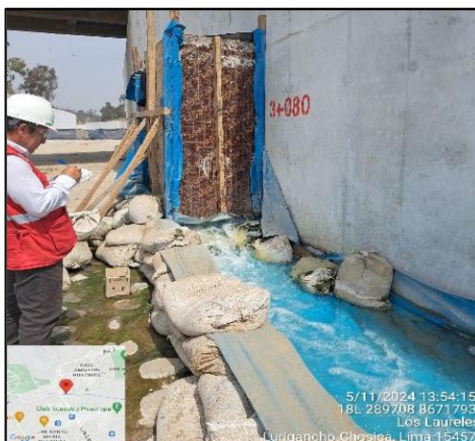
Foto N° 7: Vertimiento localizado en la progresiva 3+800 (paquete 4.1B), según señala el Contratista pertenece a la empresa AMBEV Perú.
