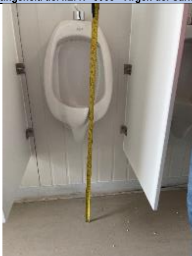
Fotografía N° 5: La Comisión de Control advirtió que la altura del Urinario de los Servicios Higiénicos de varones de Primaria es de 66 cm.
