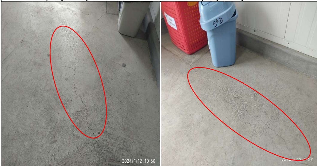
Fotografía N° 17: Vista de fisura en el piso a la entrada del aula 7.
