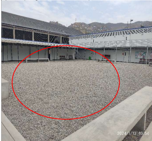
Fotografía N° 27: Vista exterior de patio, no se advierte la señalización de la zona segura.
