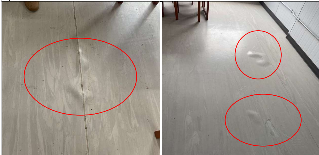
Fotografía N° 33: Vista interior de piso levantado en aula 13 (formación de bolsa de aire).
