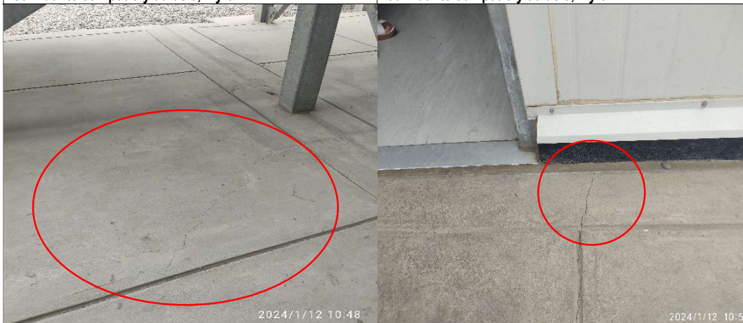
Fotografía N° 15: Vista de fisura en área de circulación colindante con patio y aulas 6 y 7.
