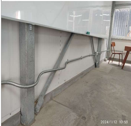
Fotografía N° 21: Vista de tuberías metálicas que no cuentan con abrazaderas en el aula 8.
