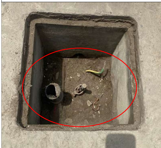
Fotografía N° 23: Vista de uno de los tres pozos a tierra, no se advierte la conexión del cableado a la varilla de pozo.
