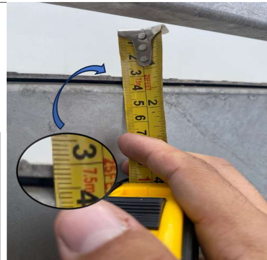
Fotografía N° 22: Vista del espesor de la plancha metálica colocada en el piso exterior del segundo nivel con un espesor aproximado de 2,5 milímetros (inferior a 3 mm).
