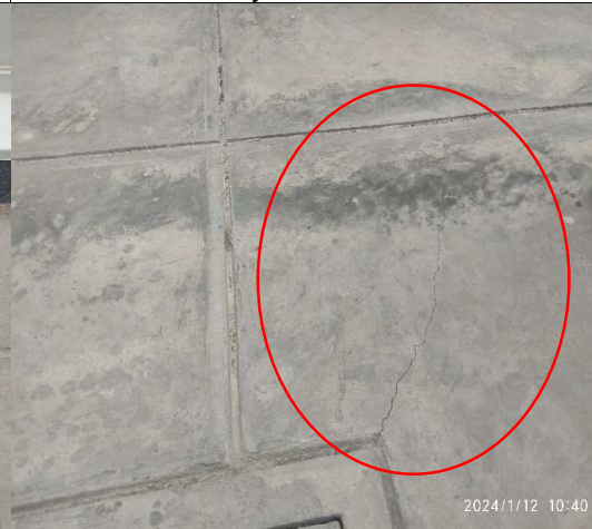
Fotografía N° 12: Vista de fisura en área de circulación colindante con patio
