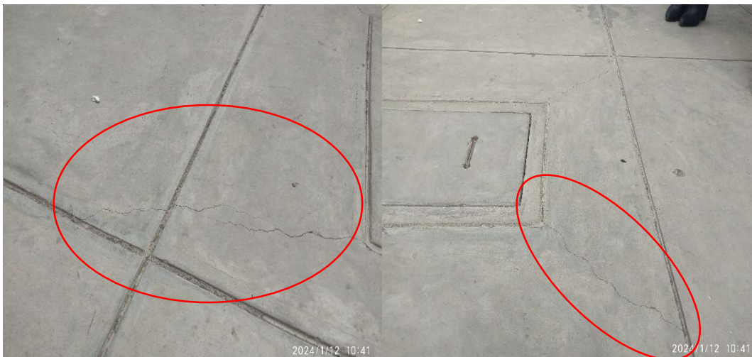
Fotografía N° 13: Vista de fisura en área de circulación colindante con patio y aulas 3, 4 y 5.
