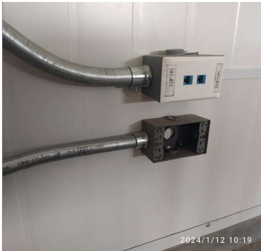
Fotografía N° 19: Vista de conexiones incompletas de tomacorrientes en sala de docentes.
