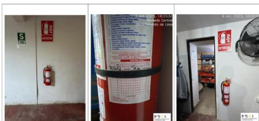
Ref. fotografía N° 9: Extintor instalado cumpliendo con los espacios establecidos según norma.
