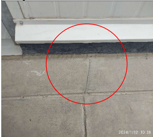
Fotografía N° 11: Vista de fisura en área de circulación colindante con aulas 1 y 2.
