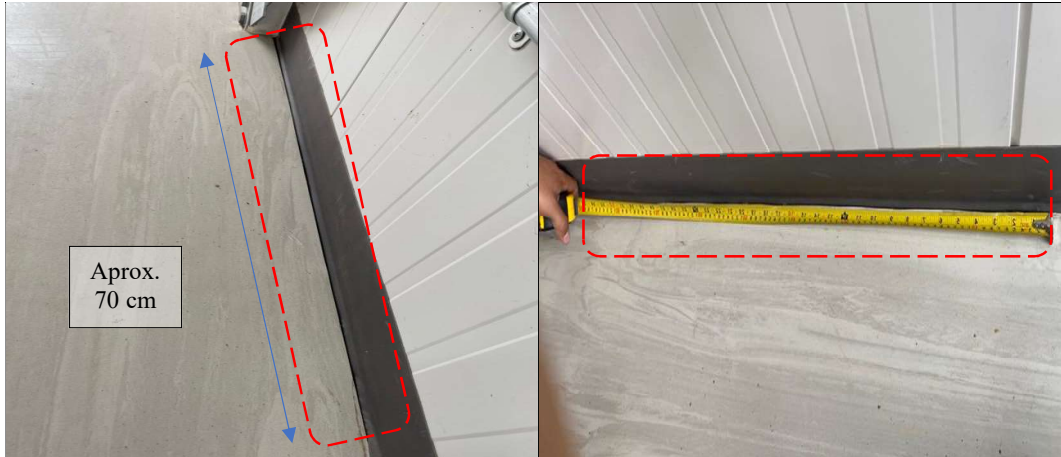
Fotografía N° 31: Vista de la separación entre la unión del piso y el contrazócalo, en aula 14 con una longitud aproximada de 70 centímetros.
