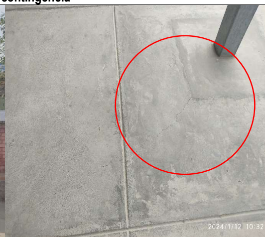
Fotografía N° 10: Vista de fisura en área de circulación colindante con aulas 1 y 2.
