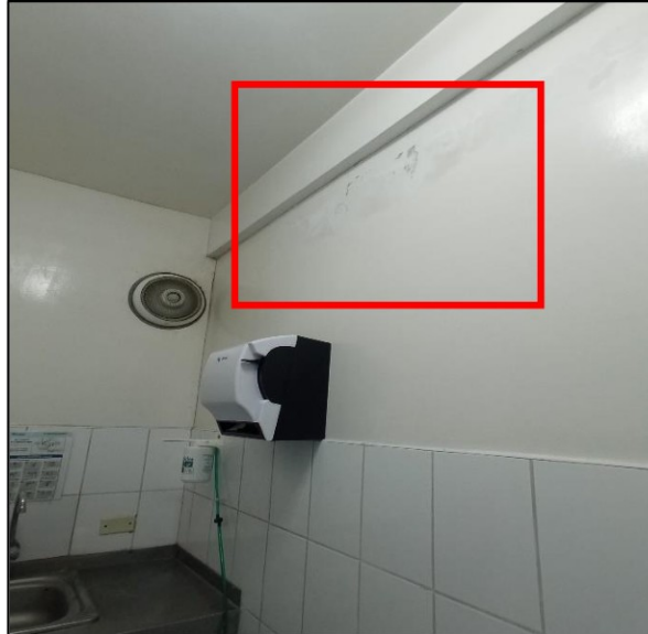
Imagen n.º 5 Presencia de humedad en muros de zona de esclusa
