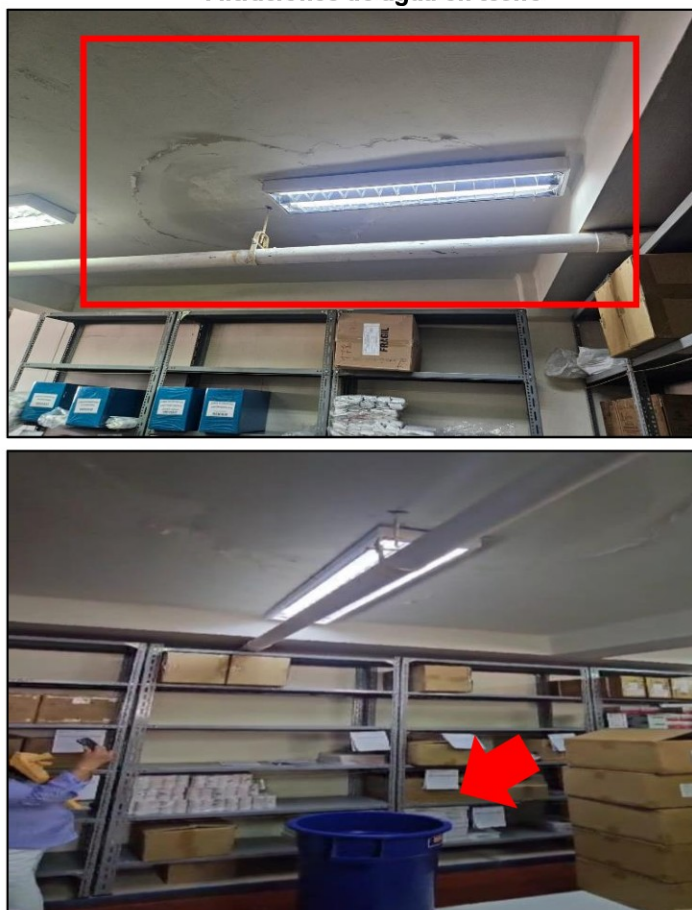
Imágenes n.° 17 y 18 Filtraciones de agua en techo
