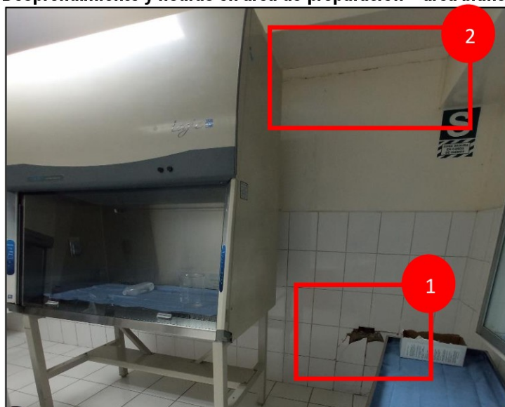
Imagen n.º 3 Desprendimiento y fisuras en área de preparación – área blanca
