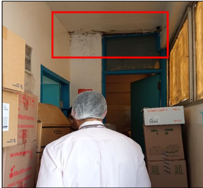
Imagen n.º 1 Presencia de humedad en zona de ingreso
