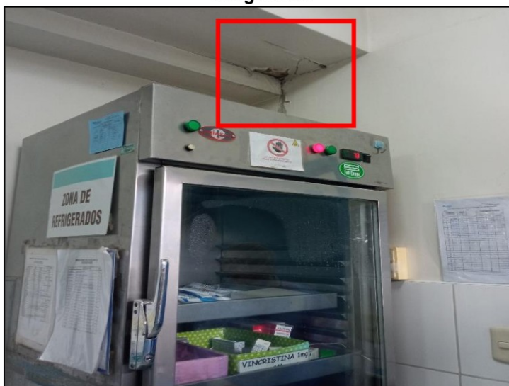
Imagen n.º 4 Fisura cerca de encuentro de pared y techo en zona de refrigerados
