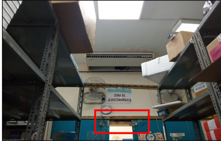
Imagen n.º 15 Falta de seguridad en puerta de farmacia
