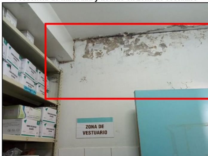
Imagen n.º 2 Presencia de humedad y fisuras en zona de vestuario
