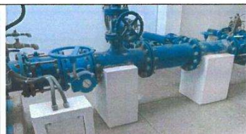
Accesorios de la tubería de Impulsión del Pozo PP-02, apoyados en dados de concreto.
