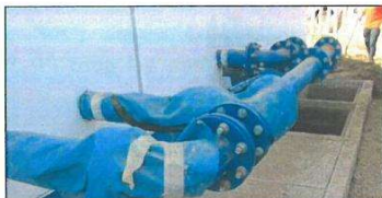
Tubería de rebose del Pozo PP-03 sin apoyo de dados de concreto
