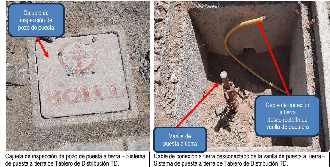
Imagen N° 05: Cable de conexión a tierra desconectado de varilla de puesta a tierra, Sistema de puesta a Tierra del Tablero de distribución TD – Caseta de Válvulas del Reservorio R3
