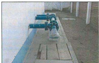
Caja de rebose del PP-02 se encuentra sin rejilla, se encuentra tapada con madera.
