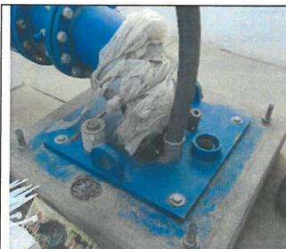
Pozo PP-03 cuenta con sello sanitario.
