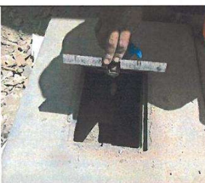
Tapa de la caja de conexiones domiciliaria del domicilio Mz U° lote 4-sector PROMUVI-Buena Villa.
