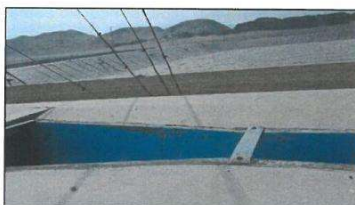
Canal Pashall ejecutado en zona de ingreso a la PTAR para medir el caudal que viene de cámara de rejás.
