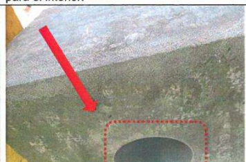
Tubería de Ventilación embebida en concreto no cuenta con malla de seguridad.
