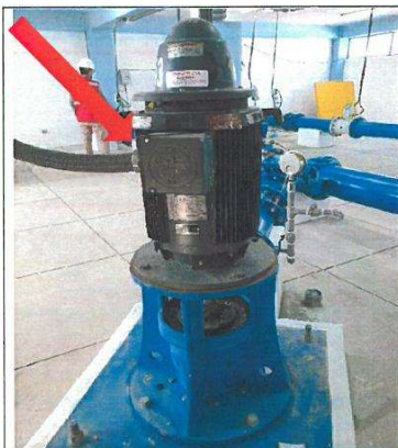
Electrobomba de impulsión energizada y en operación, cajuela con resistencia de control de humedad desconectada, debe operar a 115 voltios
