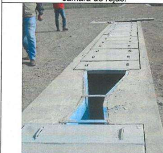
Canal Pashall ejecutado en zona de salida de la PTAR para medir el caudal del efluente que viene de los humedales.
