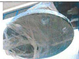
Detalle codo de la Tubería de rebose del Pozo PP-02, sin malla de protección.
