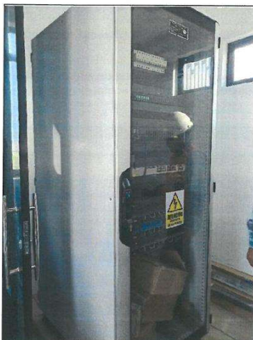
"Tablero eléctrico de Scada" ubicado en la sala de Control del Sistema escada.
