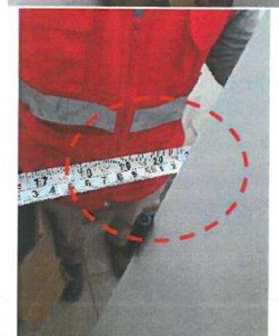
Espacio disponible de 51 cm entre puertas de acceso posterior de tablero eléctrico y pared adyacente.
