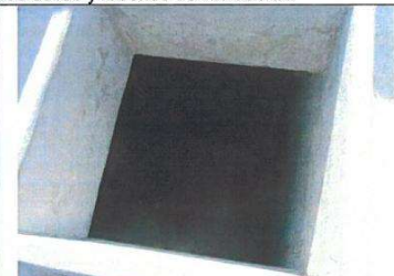
Interior de cámara seca de la cisterna de agua potable, faltan la instalación de las electrobombas; y falta escalera de acceso para el interior.
