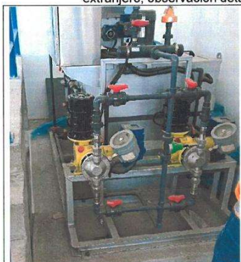
Equipamiento electromecánico ubicado en sala de Dosificación de Polímeros
