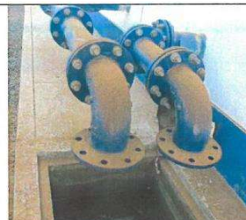
Detalle codo de la Tubería de rebose del Pozo PP-03, sin malla de protección y la caja de rebose no tiene rejilla.
