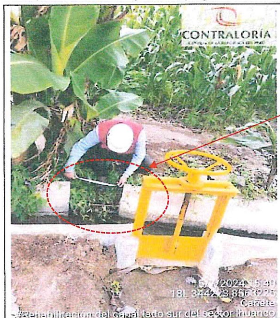
Imagen 09 Sección de pared de canal no ejecutada, progresiva 0+170 km.
