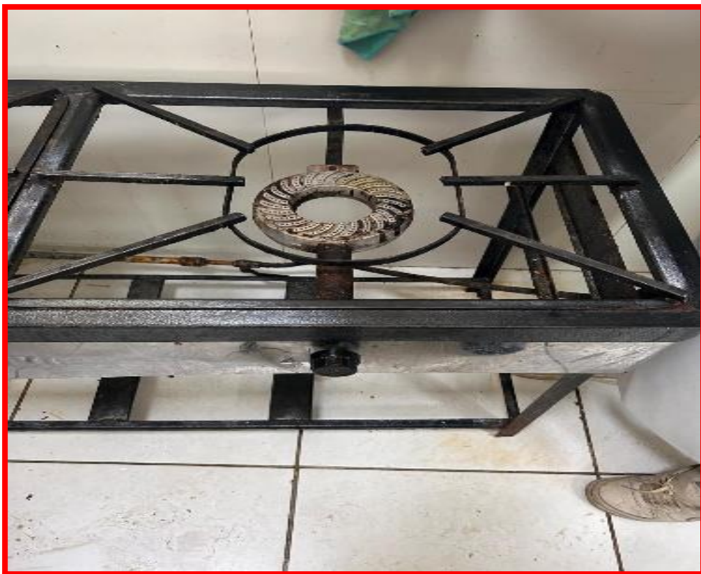
Imagen n.º 16 Cocina industrial defectuosa, solo funcionan dos hornillas de tres hornillas que posee
