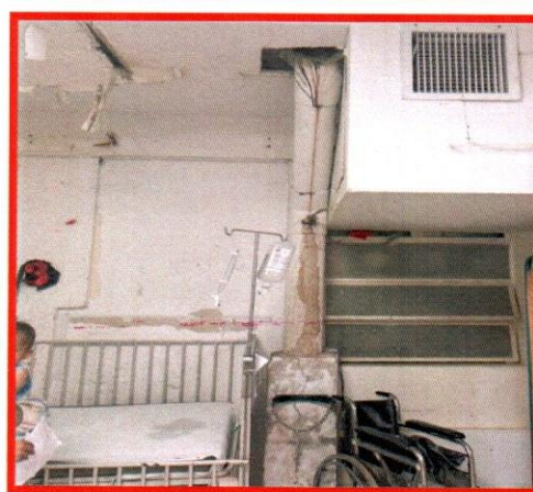
Imagen N°14 Presencia moho en pared y techo por desprenderse
