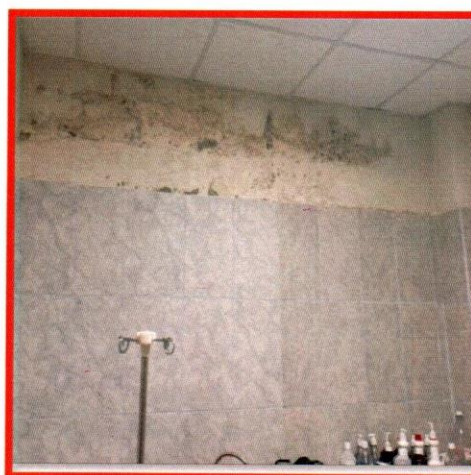
Imagen N°12 Presencia de Moho en la pared de UCI
