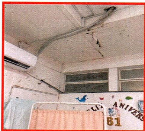
Imagen N°15 Techos con humedad y moho
