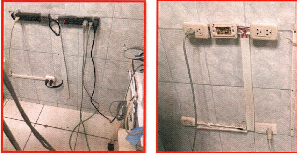
Imagen N°4 y 5 Instalaciones electricas inadecuadas
