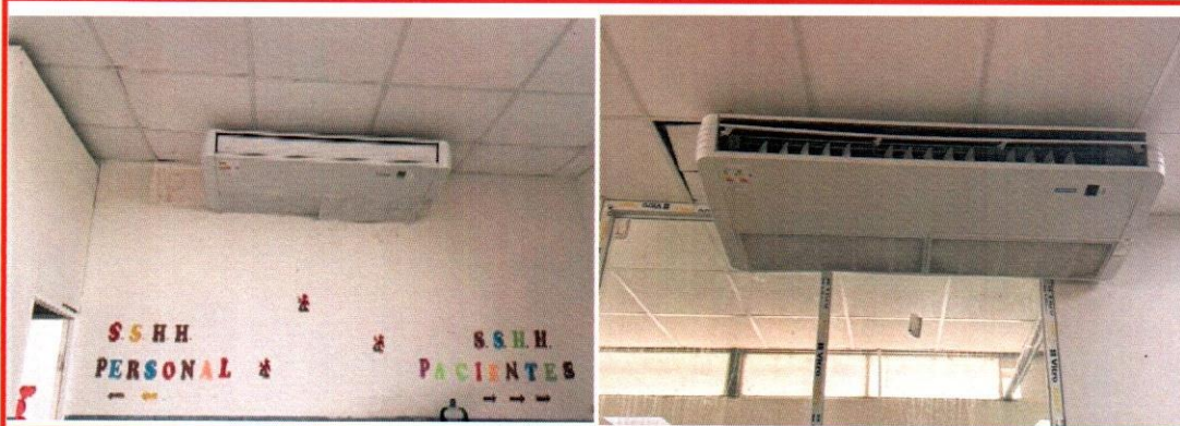
Imagen N°9 y 10 Equipos de aire acondicionado
