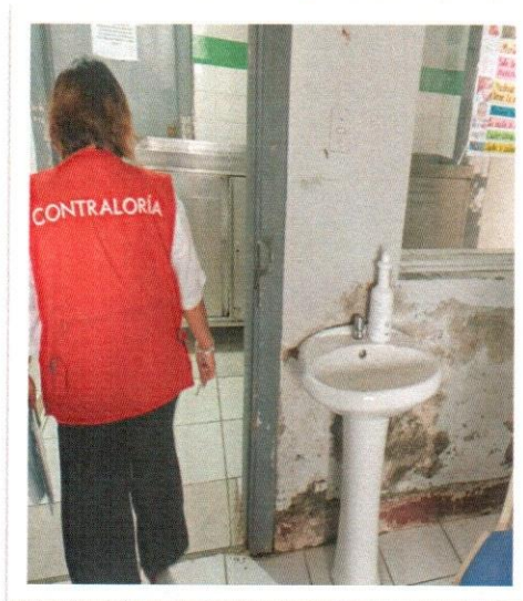
Imagen n.º 7 Pared con moho y suciedad
