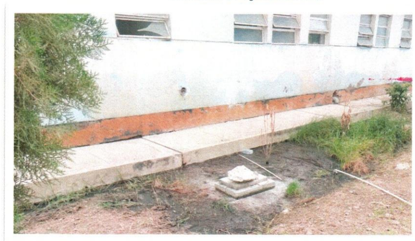
Imagen n.º 10 Presencia de aguas servidas
