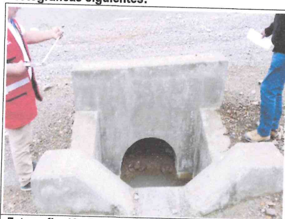
Fotografía 13: Progresiva 42+310 aprox., alcantarilla colmatada.
