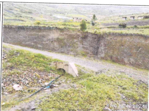
Fotografía 14: Progresiva 56+520 aprox., alcantarilla colmatada.
