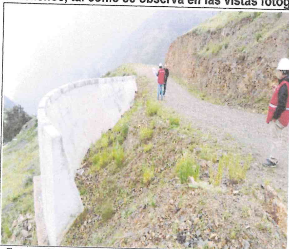
Fotografía 21: Progresiva 56+160 aprox. ubicación de muro de contención sin rellenos compactados.
