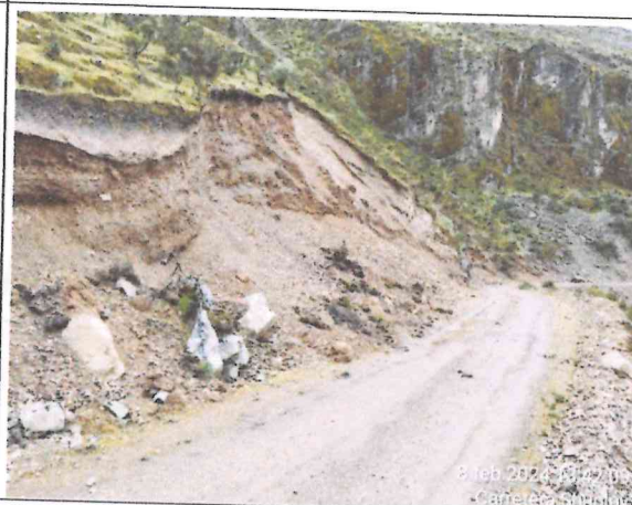
Fotografía 12: Progresiva 50+000 aprox., talud inestable con presencia de derrumbes.
