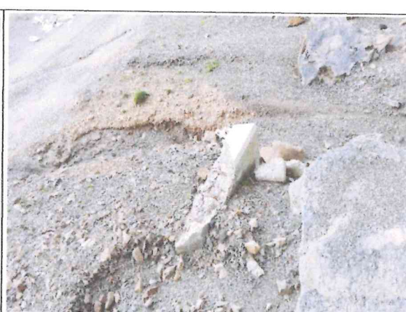
Fotografía 16: Progresiva 18+440, alcantarilla colmatada en cabezal de entrada.
