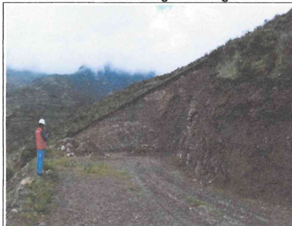
Fotografía 7: Progresiva 54+240, talud inestable con presencia de deslizamiento de rocas.
