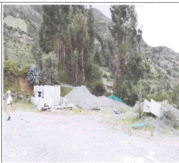
Fotografía 31: Tapas de concreto para alcantarillas rectangulares y agregados, elementos expuestos a la intemperie.
