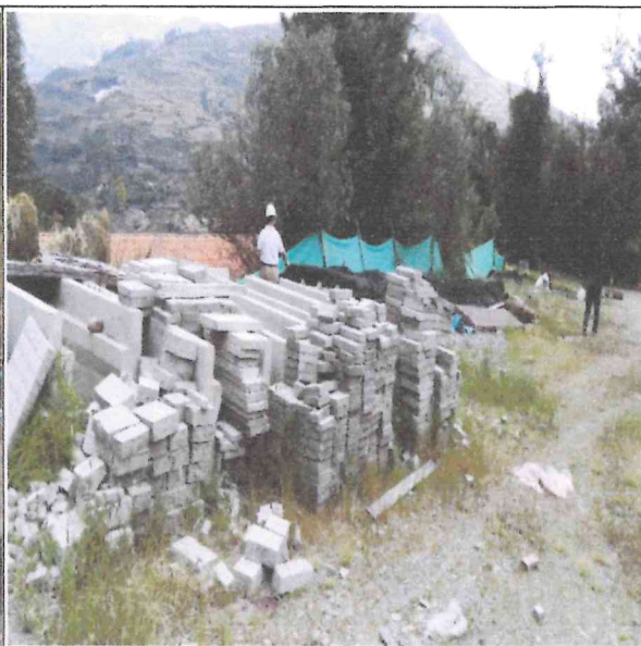
Fotografía 29: Tapas de concreto para alcantarillas rectangulares y fierros corrugados cubierto con manto negro, elementos expuestos a la intemperie.
