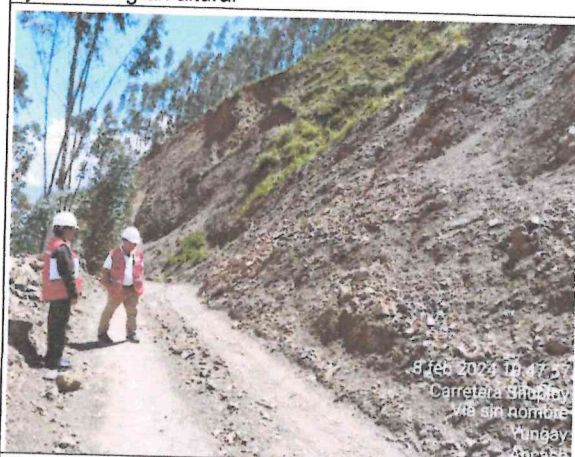
Fotografía 11: Progresiva 13+040, presencia de derrumbes y talud de gran altura.
