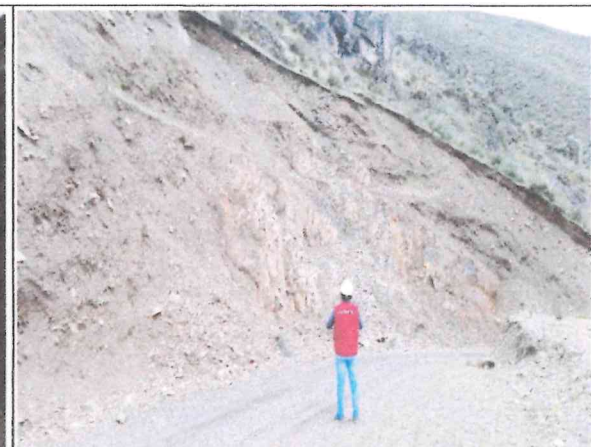
Fotografía 8: Progresiva 54+000, talud inestable de gran altura, con presencia de desprendimiento de rocas.
