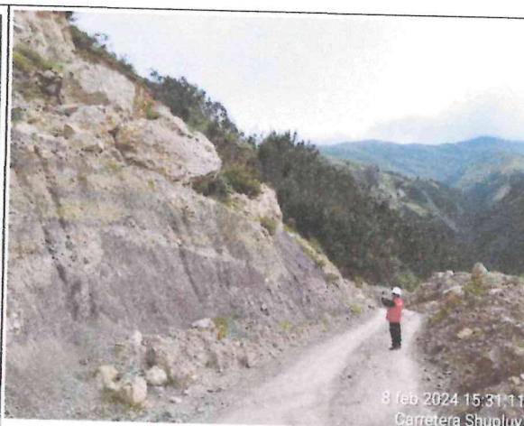
Fotografía 10: Progresiva 10+160 aprox., talud inestable en zona ubicado PTAR, plataforma reducida por derrumbes.
