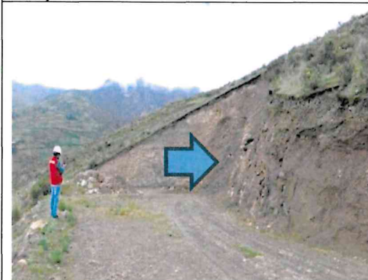
Fotografía n.º 5: Progresiva km 54+240, talud inestable con presencia de deslizamiento de rocas en curva horizontal, no cuenta con cunetas para drenaje.
