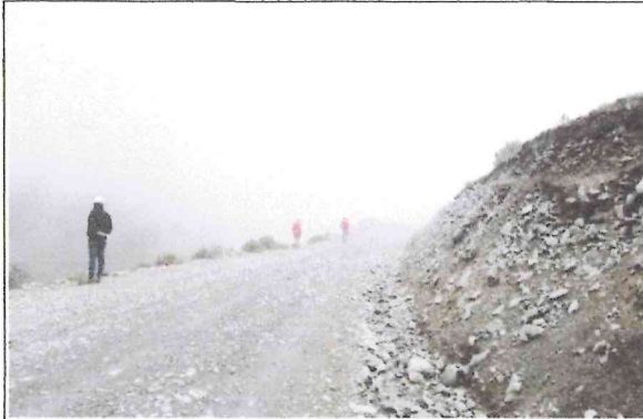
Fotografía 3: Progresiva 42+140, vista de plataforma en malas condiciones, cunetas sin tratamiento, plataforma con ahuellamiento.
