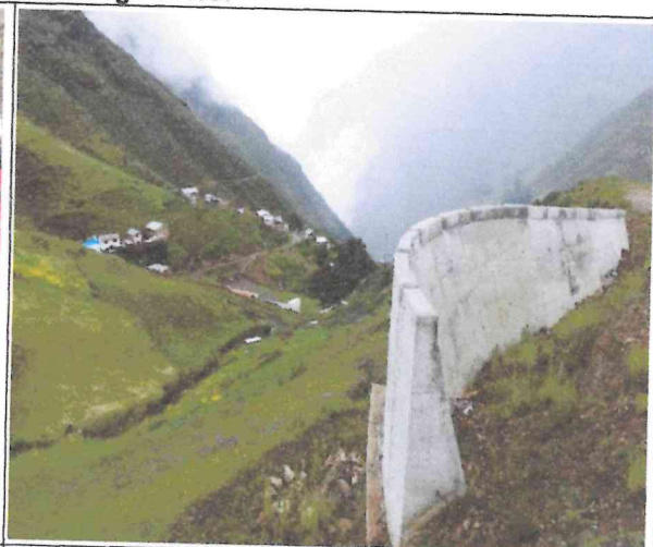
Fotografía 22: Muro de contención sin rellenos compactados cerca de Putaca.
