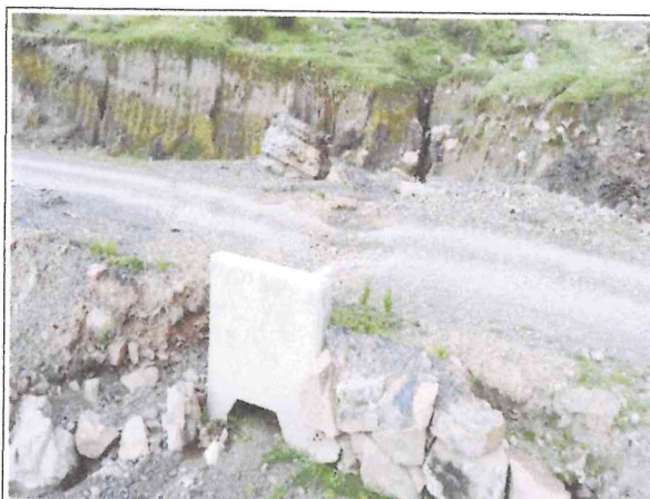
Fotografía 15: Progresiva 18+440, alcantarilla colmatada, con socavación por los lados laterales del cabezal de salida, plataforma con socavación.
