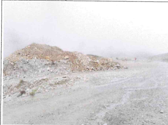
Fotografía 19: Progresiva 41+400 aprox. ubicación de DME 04 Deposito de material excedente en uso, material acumulado sin reconformar.
