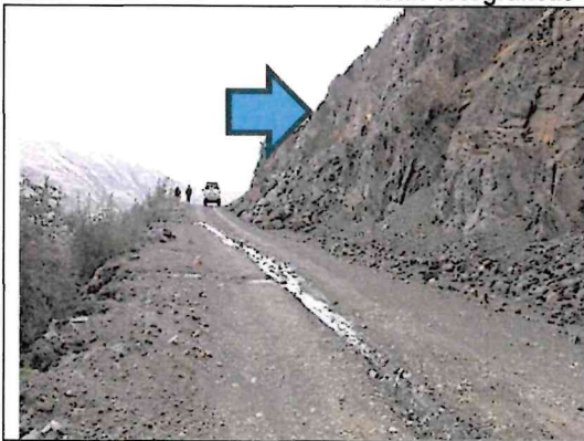
Fotografía n.º 3: Progresiva km 18+440, la plataforma presenta erosión por aguas pluviales, presencia de derrumbes y talud de gran altura, faltan cunetas para drenaje.
