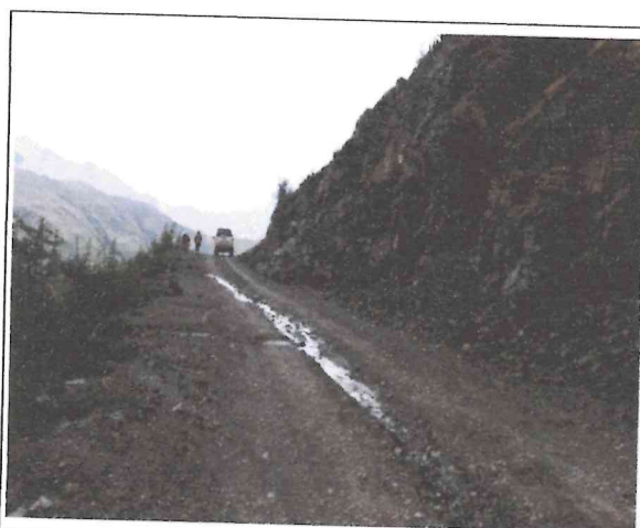
Fotografía 9: Progresiva 18+440, la plataforma presenta socavación por aguas pluviales, presencia de derrumbes y talud de gran altura.
