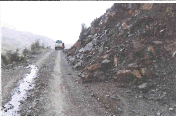
Fotografía 4: Progresiva 18+460 aprox., la plataforma presenta socavación por aguas pluviales, presencia de derrumbes en la vía, no cuenta con cunetas.
