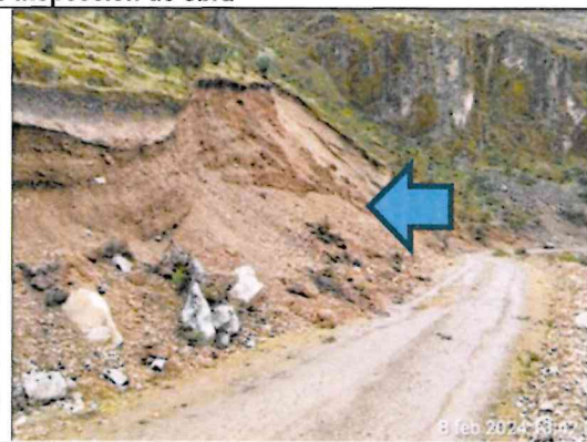
Fotografía n.º 4: Progresiva km 50+000 aprox., talud inestable con derrumbes, plataforma reducida por derrumbes, no cuenta con cunetas para drenaje.
