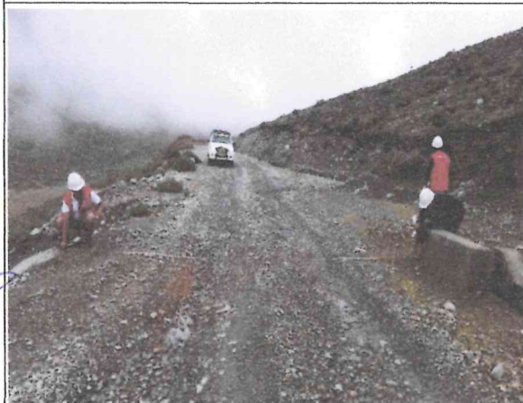
Fotografía 5: Progresiva 42+310 aprox., vista de plataforma en malas condiciones, ancho de plataforma de 5.95m en alcantarilla.
