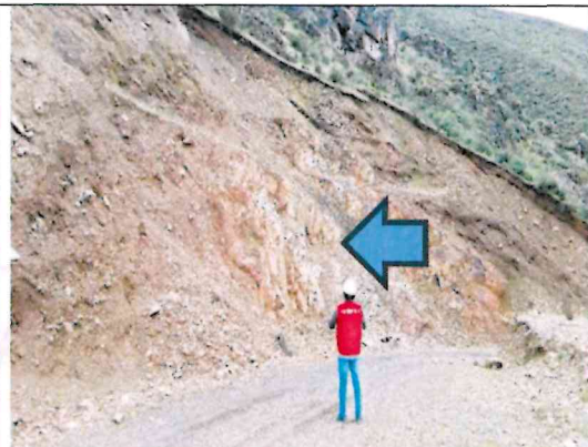
Fotografía n.º 6: Progresiva km 54+000, talud inestable de gran altura, con presencia de desprendimiento de rocas, plataforma reducida por derrumbes.
