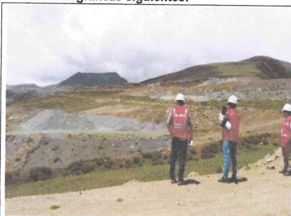
Fotografía 17: Progresiva 22+400 aprox. ubicación de DME 01 Deposito de material excedente en uso como depósito de material granular.
