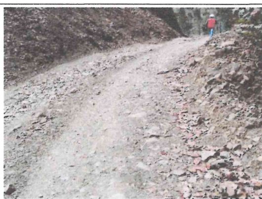
Fotografía 2: Progresiva 13+040, la plataforma se encuentra en malas condiciones, presenta ahuellamiento, bacheos, no cuenta con cunetas para drenaje pluvial.
