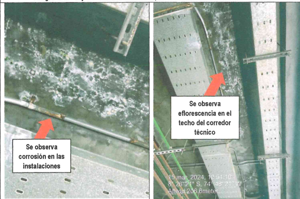
Fotografías n.º 21 y 22: Se constató la presencia de eflorescencia en techo y corrosión en instalaciones ubicadas en el corredor técnico del 2do nivel – Zona B1
