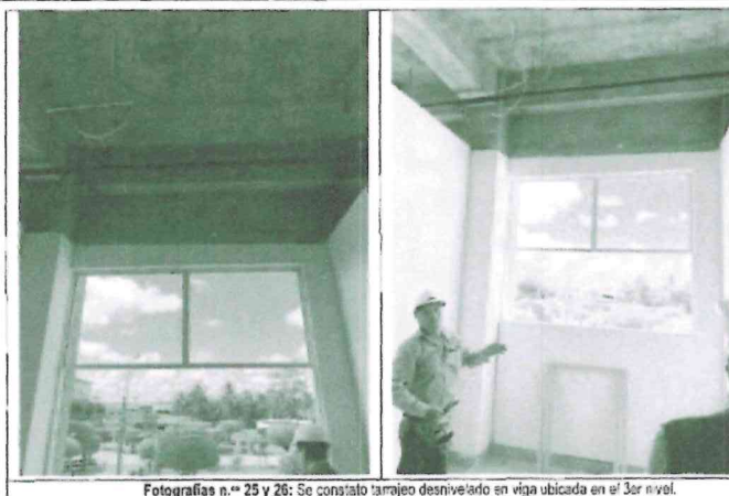
Fotografías n.º 25 y 26: Se constata tarrajeo desnivelado en viga ubicada en el 3er nivel.
