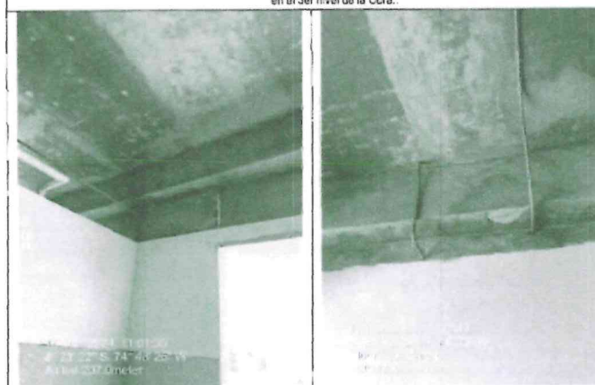
Fotografías n.º 19 y 20: Se evidenció el desprendimiento del solaquero (agua y cemento) en elementos estructurales (vigas peraltadas).
