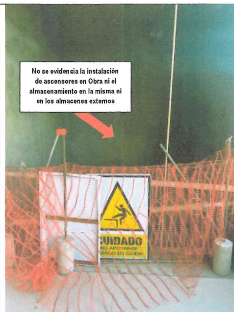
Fotografía n.º 04: Se constató que las partidas correspondientes a Ascensores aún no han sido instaladas ni tampoco almacenadas en Obra ni en los almacenes externos del Contratista.
