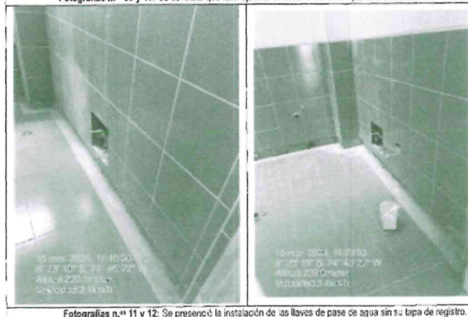
Fotografías n.º 11 y 12: Se presenció la instalación de las llaves de pase de agua sin su tipo de registro.
