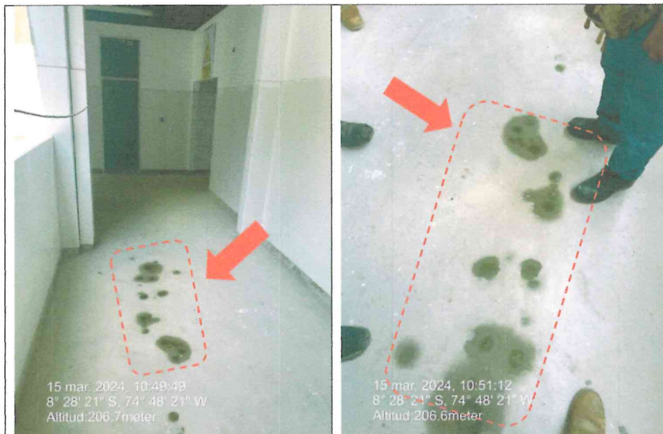
Fotografías n.º 19 y 20: Se constató humedad en piso del corredor técnico del 2do nivel – Zona B1.
