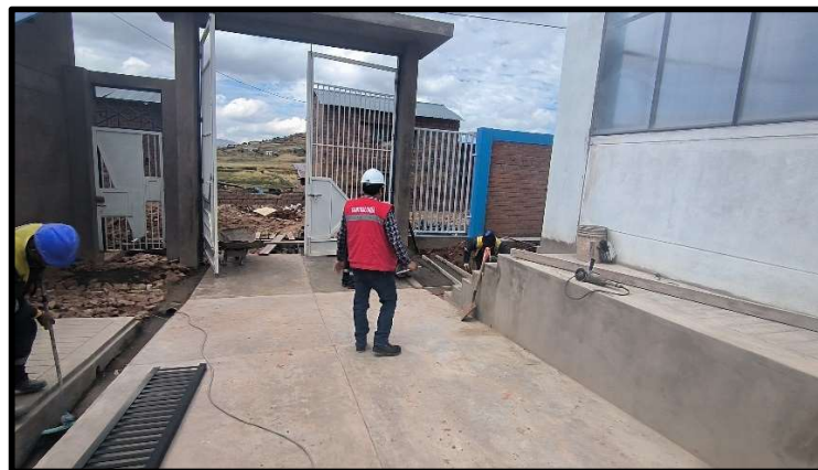
Fuente: Inspección física del proyecto, el 16 de mayo de 2024 Elaborado por: Comisión de Control
