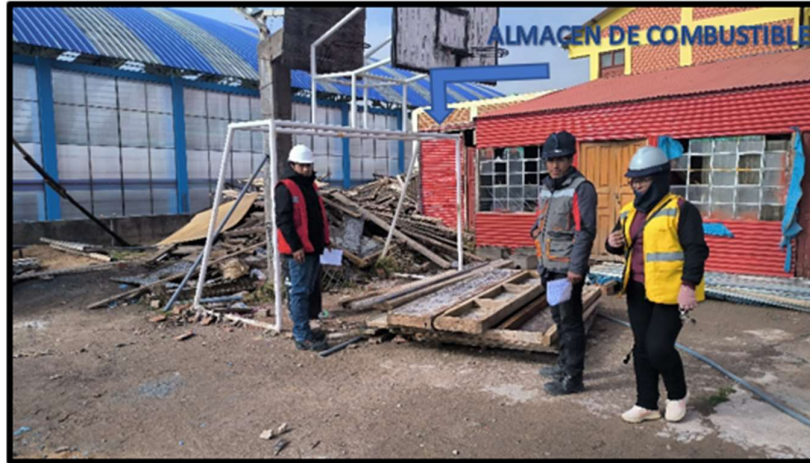
Fuente: En el exterior del almacén de combustible se evidencia escombros de madera. Elaborado por: Comisión de Control
