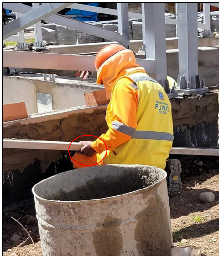
Imagen n.º 16 Personal de obra sin guantes de seguridad
