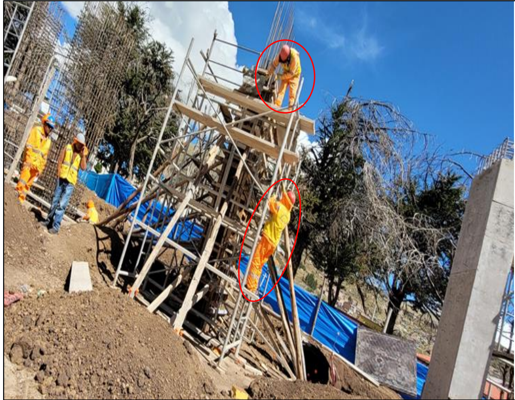
Imagen n.º 7 Personal de la obra sin el arnés de seguridad y la línea de vida
