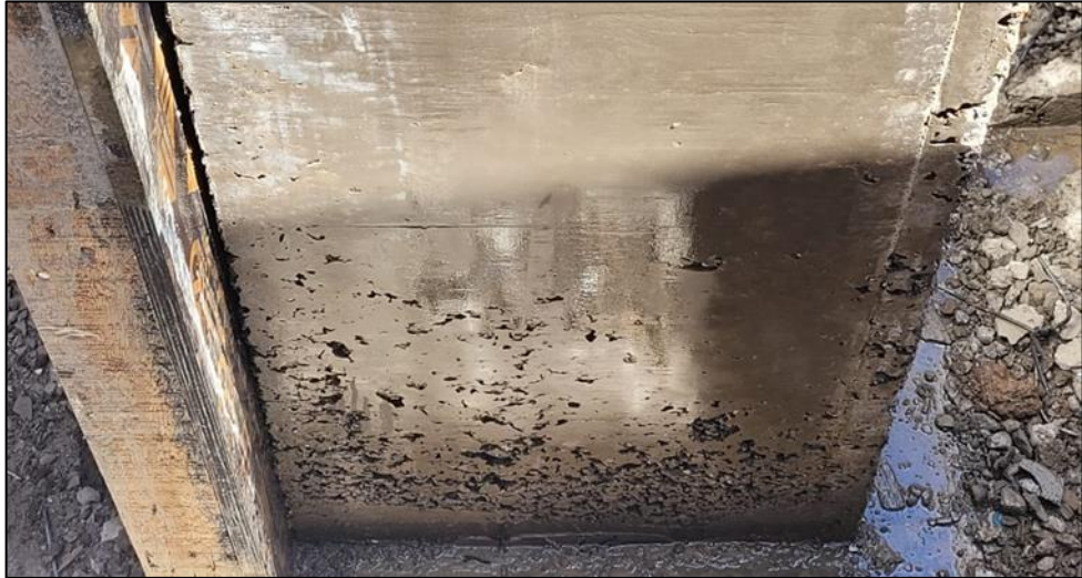
Imagen n.º 5 Cangrejas en la columna C-1 del portón de ingreso vehicular
