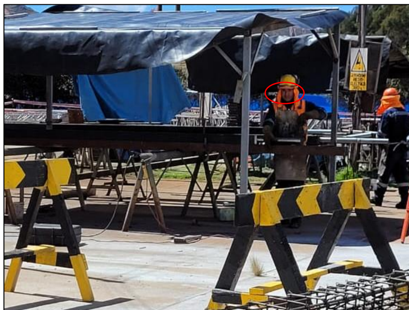
Imagen n.º 12 Personal de obra sin lentes de seguridad
