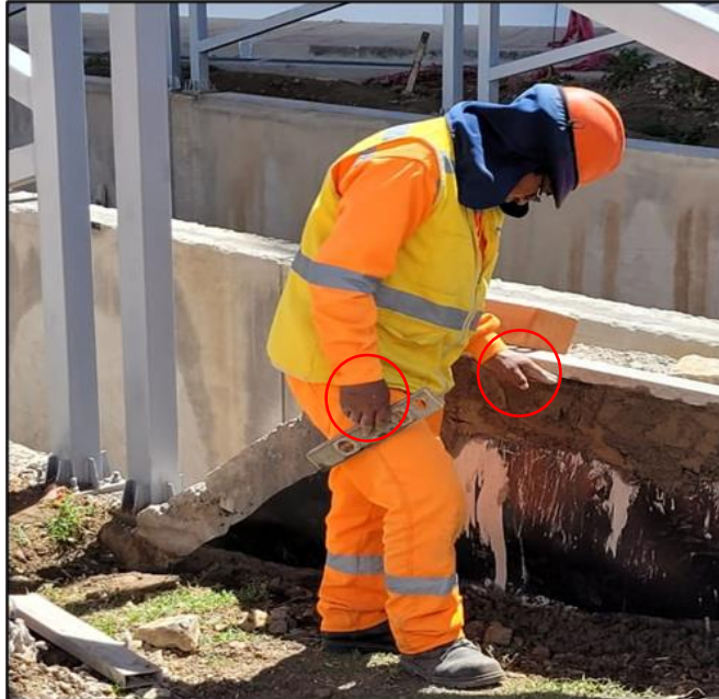
Imagen n.º 15 Personal sin guantes de seguridad
