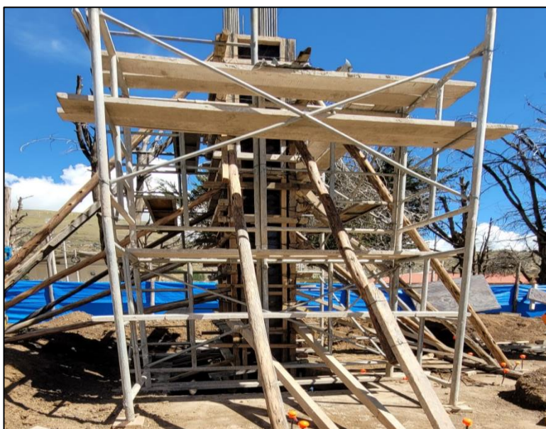
Imagen n.º 9 Andamios sin tarjetas de identificación
