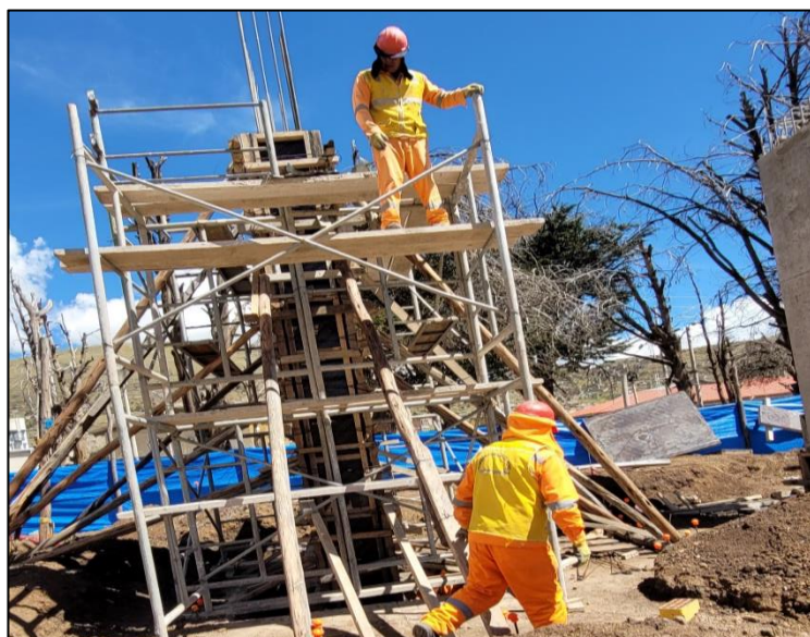
Imagen n.º 10 Andamios sin tarjetas de identificación
