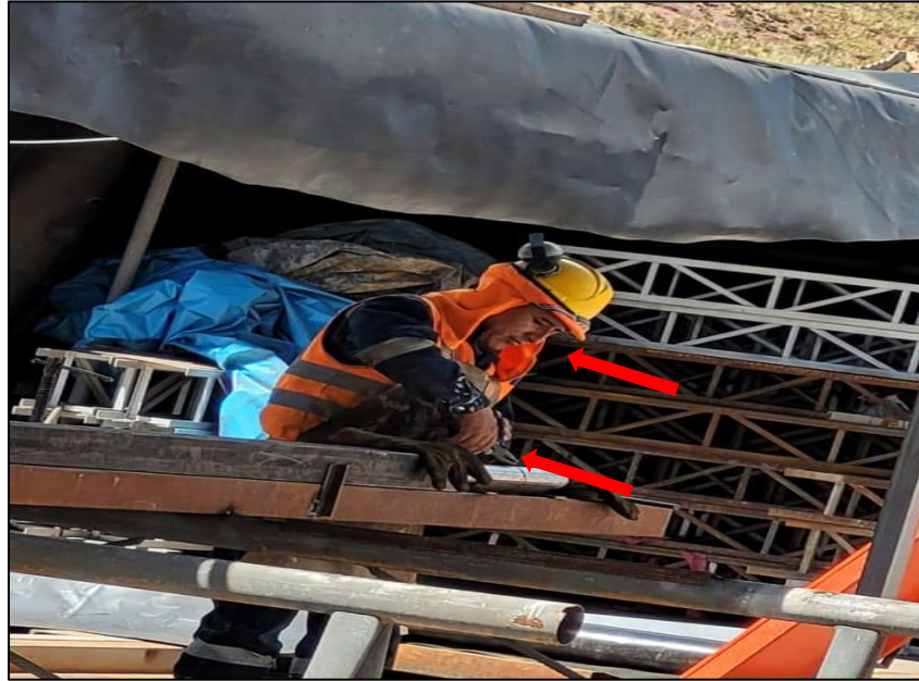
Imagen n.º 11 Personal de obra sin lentes y guantes de seguridad
