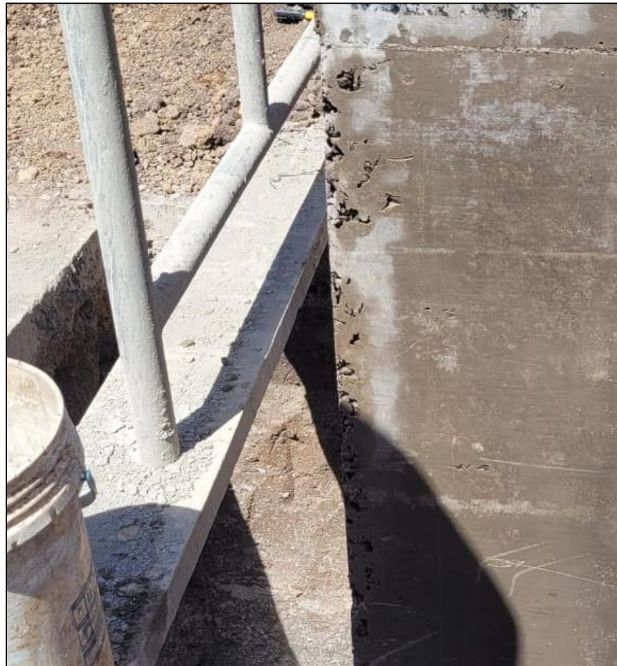
Imagen n.º 6 Cangrejas en la columna C-1 del portón de ingreso vehicular
