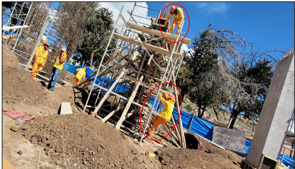
Imagen n.º 8 Personal de la obra sin el arnés de seguridad y la línea de vida
