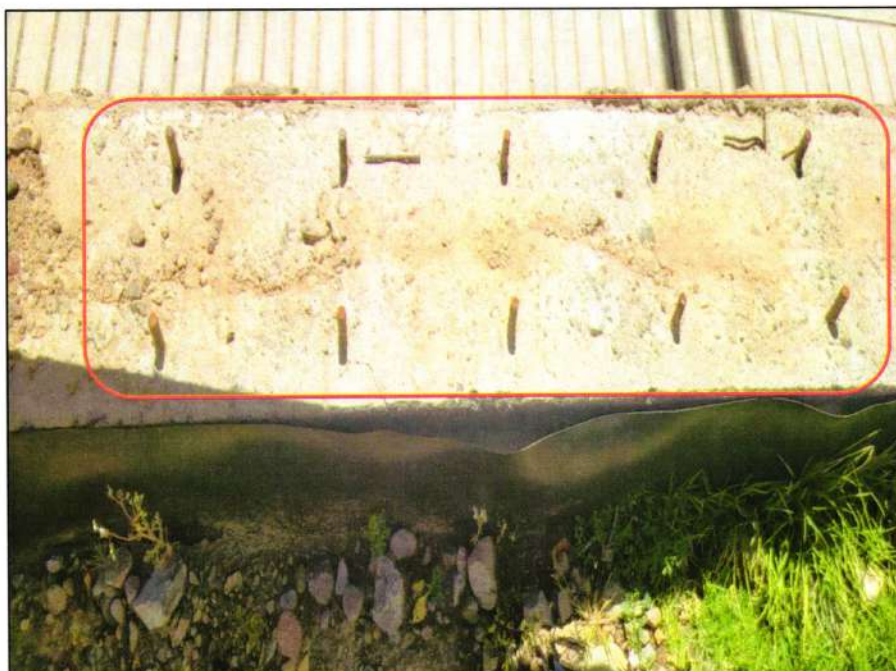
Imagen n.º 14 Varillas sin capuchones de seguridad
