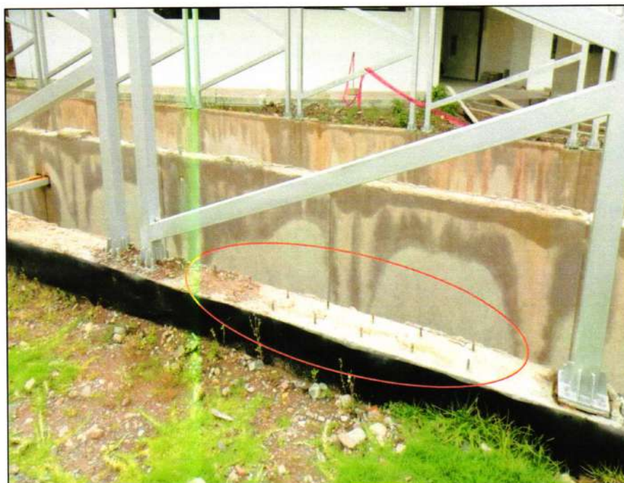
Imagen n.º 13 Varillas sin capuchones de seguridad
