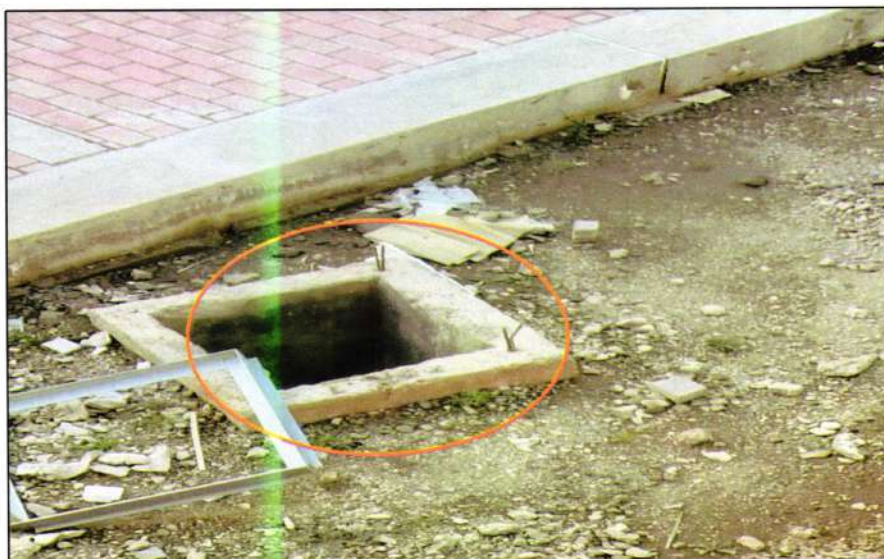
Imagen n.º 12 Varillas sin capuchones de seguridad
