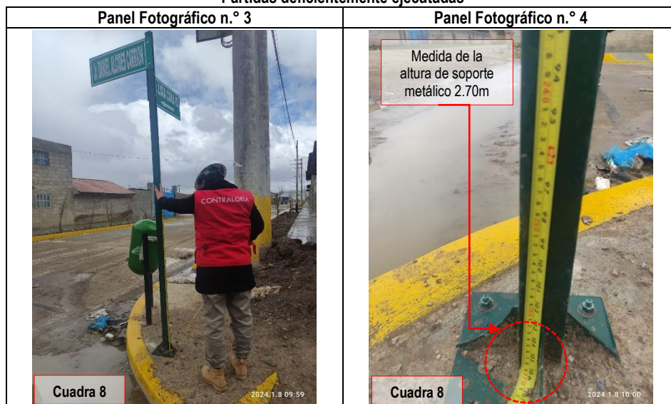
Imagen n.º 5 Partidas deficientemente ejecutadas
