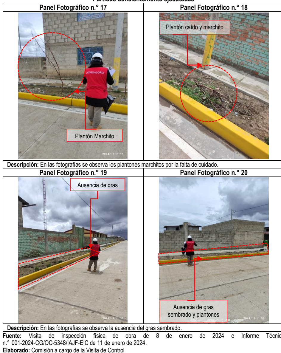
Imagen n.º 16 Partidas deficientemente ejecutadas
