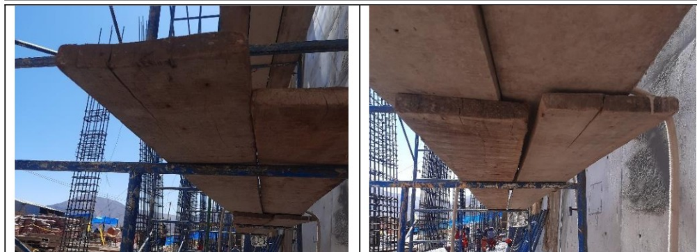
Los andamios de la obra cuentan con tablas de madera de 1 ½" de espesor con rajaduras.
