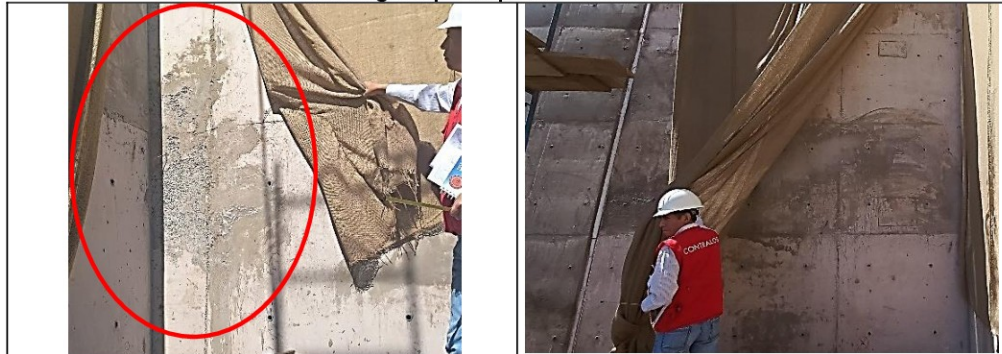
Resanes para cubrir los vacíos u oquedades en el concreto en las pantallas de los muros de contención, asimismo, las telas de yute y las superficies del concreto se encontraron completamente secas.
