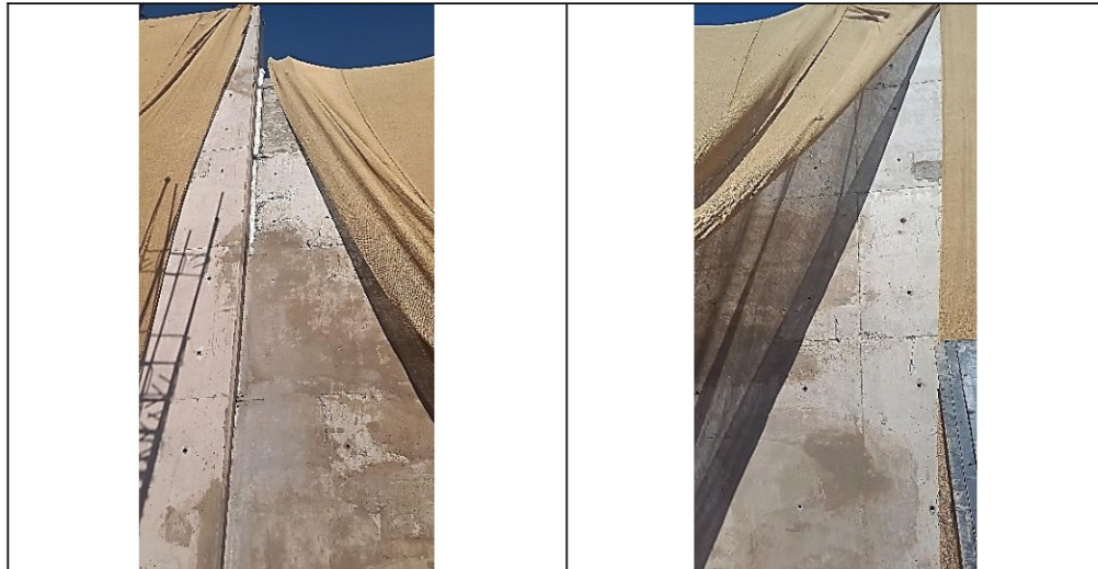
Resanes para cubrir los vacíos u oquedades en el concreto en las pantallas de los muros de contención, asimismo, las telas de yute y las superficies del concreto se encontraron completamente secas.
