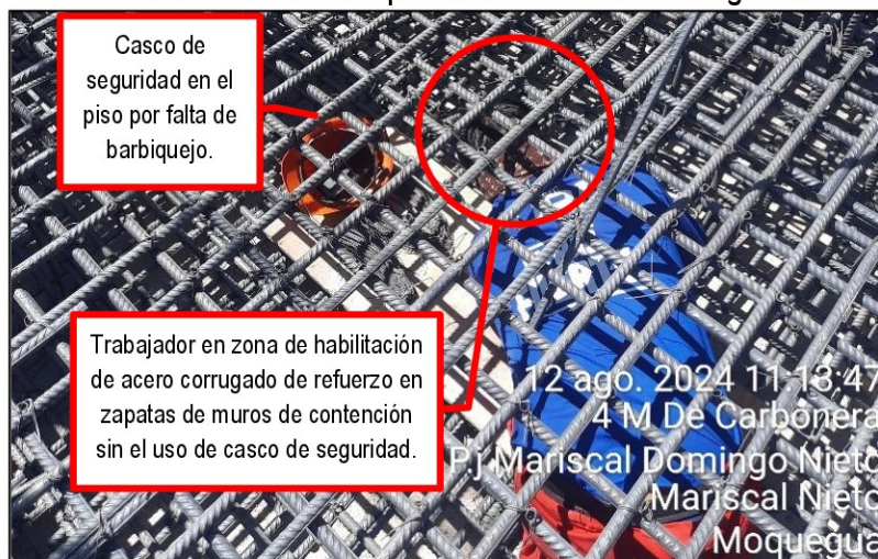
Imágenes n.º 8 Personal obrero incumpliendo el uso de casco de seguridad
