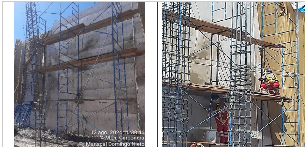
Los andamios solo cuentan con crucetas en un lado (siendo completamente inestables) y tienen 2 tablas de 1 ½" de espesor una sobre otra.
