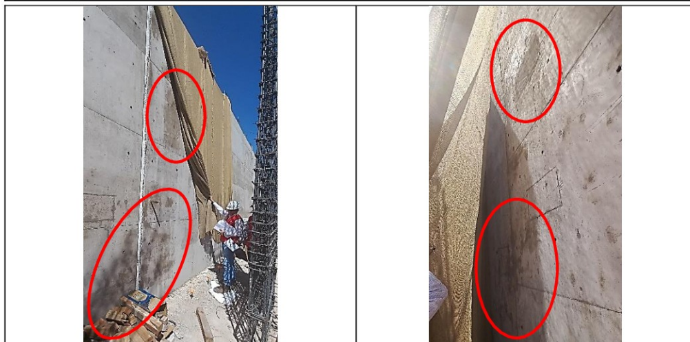
Resanes para cubrir los vacíos u oquedades en el concreto en las pantallas de los muros de contención, asimismo, las telas de yute y las superficies del concreto se encontraron completamente secas.
