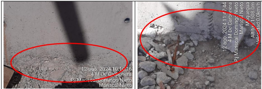
Vacios u oquedades en el concreto ubicados en la union de las pantallas y zapatas de los muros de contención.
