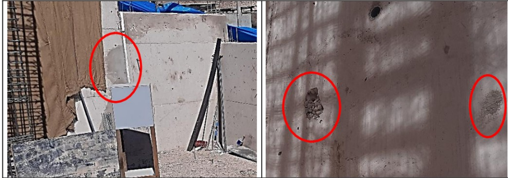
Vacios u oquedades en el concreto y resanes para cubrir estas deficiencias.
