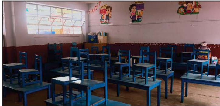
Aulas requieren pintado de muros interiores
