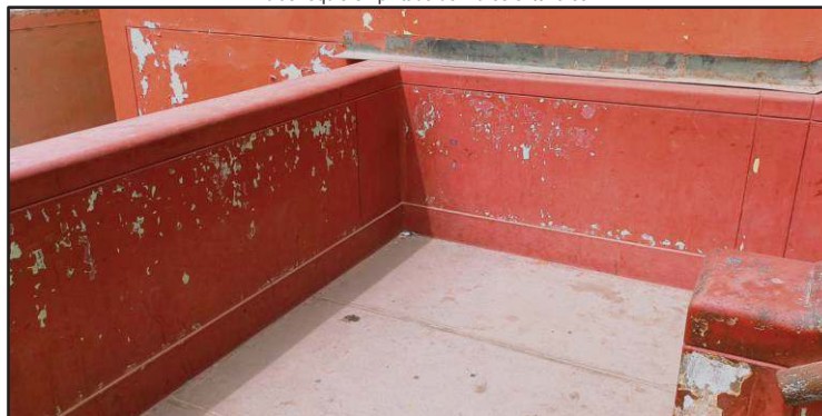
Parapeto en escalera ubicada en el pabellón 2 requiere pintado.
