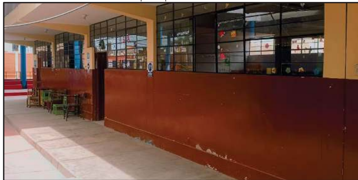
Aulas requieren pintado de muros exteriores
