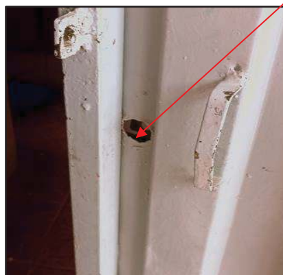
Puerta principal de los SSHH sin cerradura
