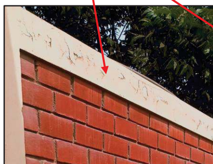
Desprendimiento de pintura en vigas del cerco perimétrico
