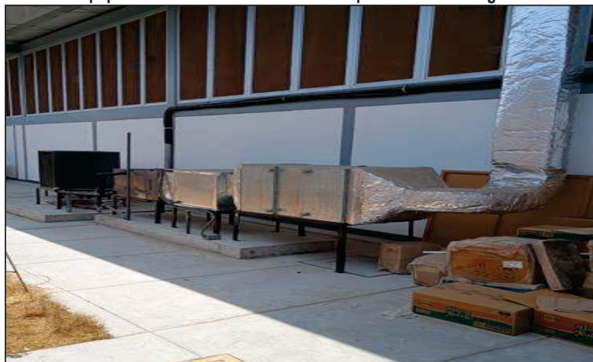
Imagen n.º 1 Equipo de Aire Acondicionado del componente de contingencia
