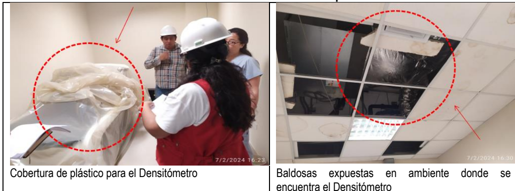
Imagen n.° 15 Densitómetro instalado en un ambiente inadecuado por falta de ventilación.
