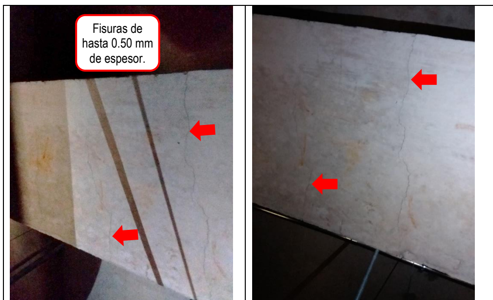
Imágenes 16 y 17.- Se observa grietas y fisuras continuas en la viga de hasta 0.50 mm de espesor, ubicada en el nivel 4 en el área de cuarto Quirúrgico.
