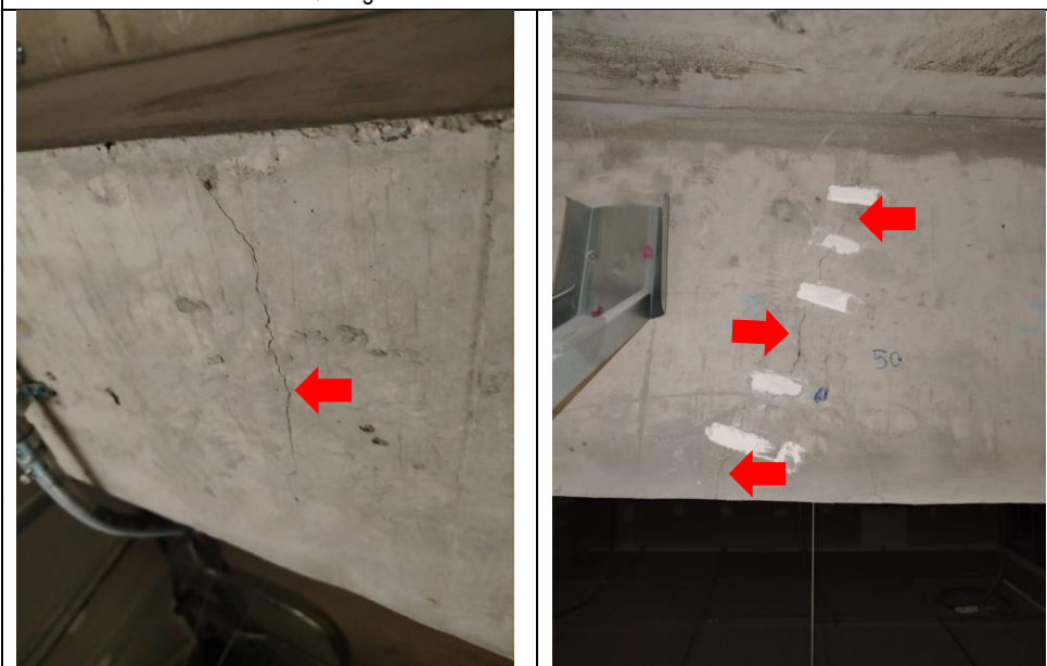
Imágenes 18 y 19.- Se observa grietas y fisuras continuas en la viga de hasta 0.50 mm de espesor, ubicada en el nivel 4 en el eje "C" en el tramo "8 al 9".
