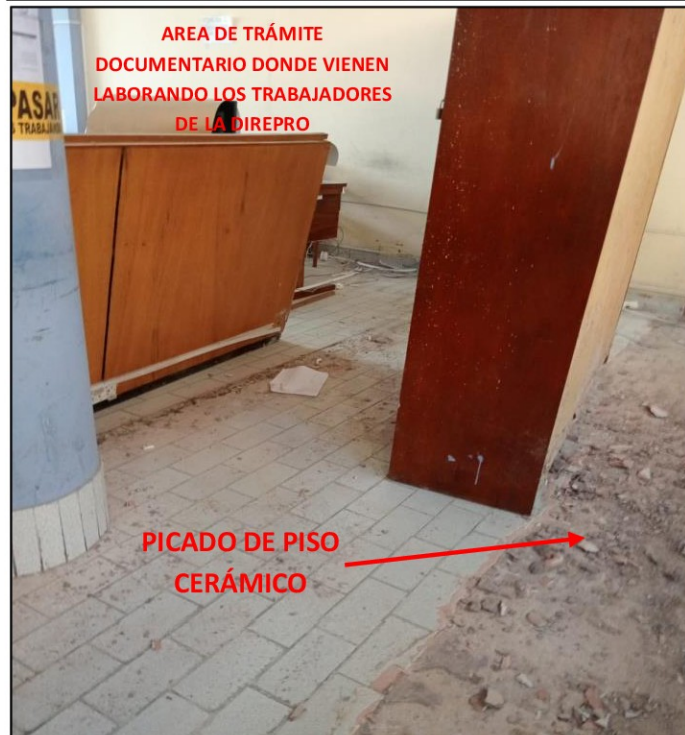
Fuente: Acta de Constatación física de 16 de setiembre de 2024. Elaborado por: Comisión de Control
