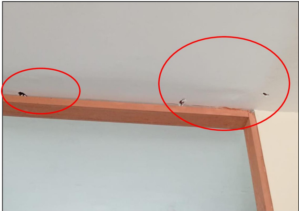
FOTOGRAFÍA N° 11 SE OBSERVAN AGUROS EN EL CIELO RASO, LUEGO DE HABER EJECUTADO LA PARTIDA PINTURA DOS MANOS EN CIELO RASO
