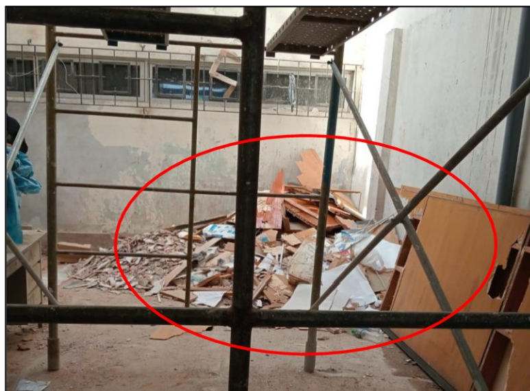
Fuente: Acta de Constatación física de 16 de setiembre de 2024. Elaborado por: Comisión de Control
