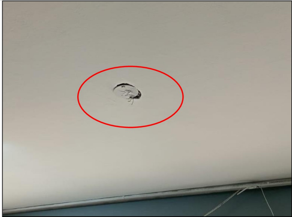
FOTOGRAFÍA N° 10 SE OBSERVA QUE NO SE HA SELLADO COMPLETAMENTE LAS CAJAS DE PASO
