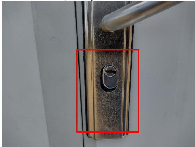
Imagen N° 13 Chapa de ingreso descuadrada
