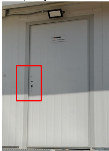
Imagen N° 14 Chapa de ingreso no instalada
