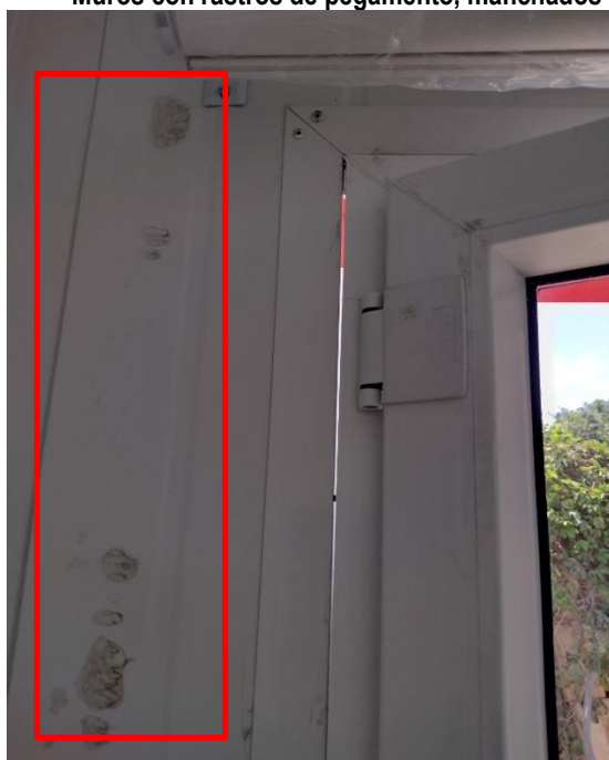
Imagen N° 19 Muros con rastros de pegamento, manchados
