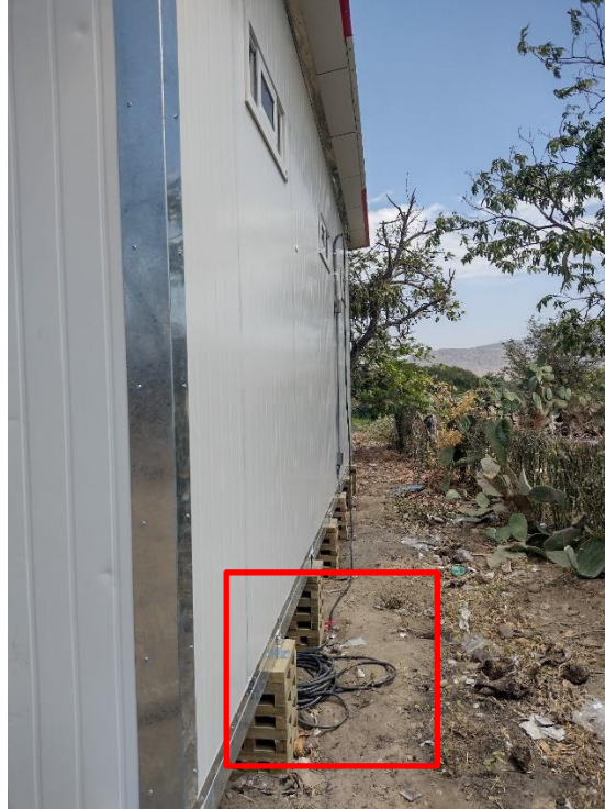
Imagen N° 29 Tuberías no se encuentran adosadas (sin abrazadera)
