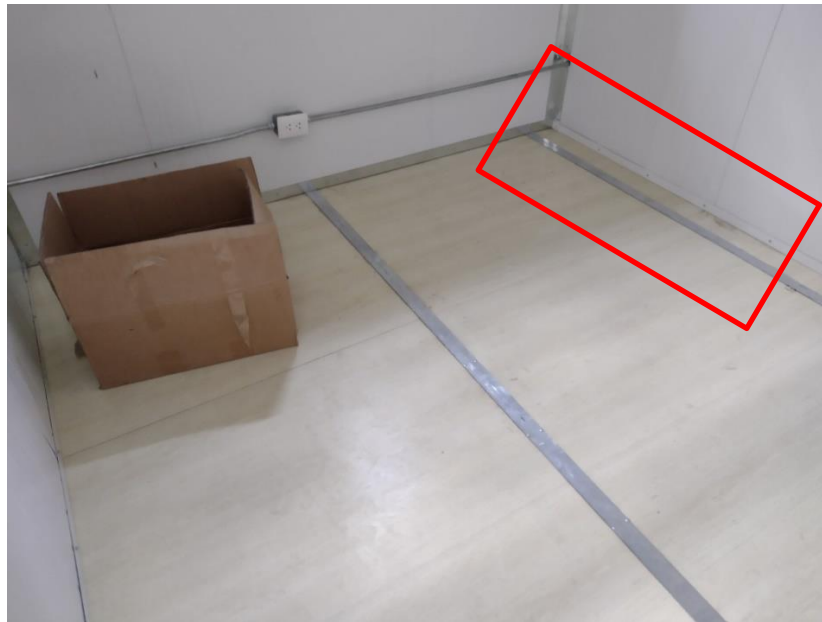
Imagen N° 16 Muros divisorios instalados en ubicación distinta
