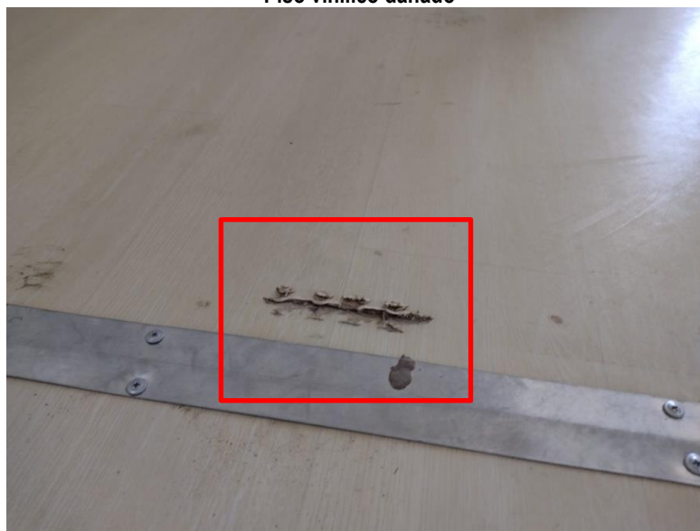
Imagen N° 18 Piso vinílico dañado
