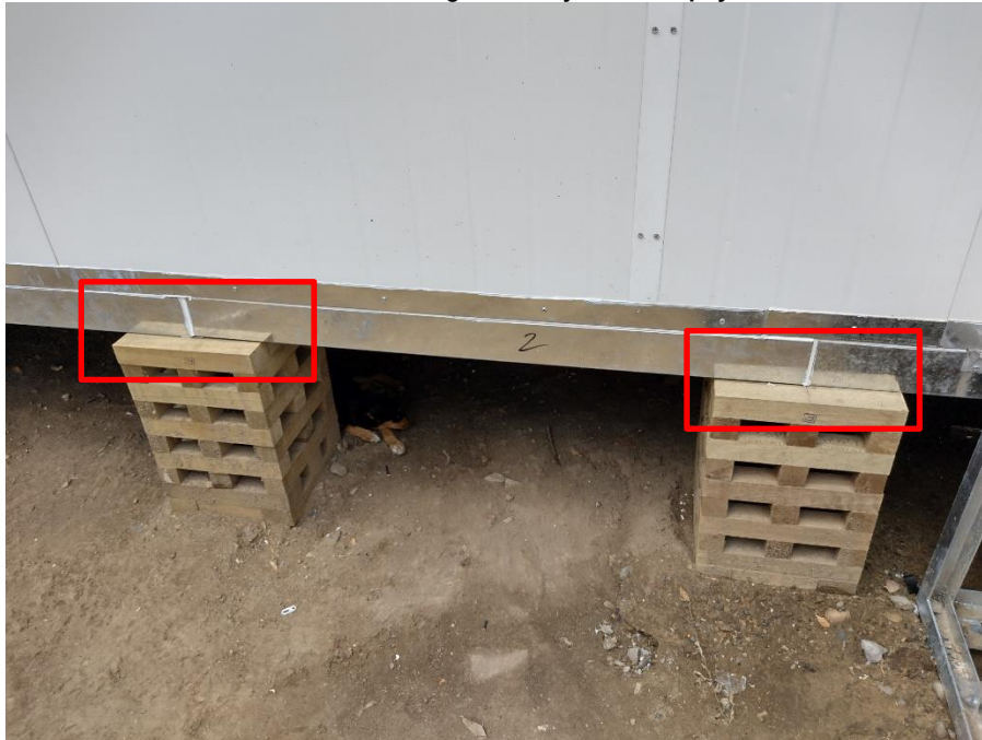
Imagen N° 4 Inexistencia de ángulos de fijación en apoyos
