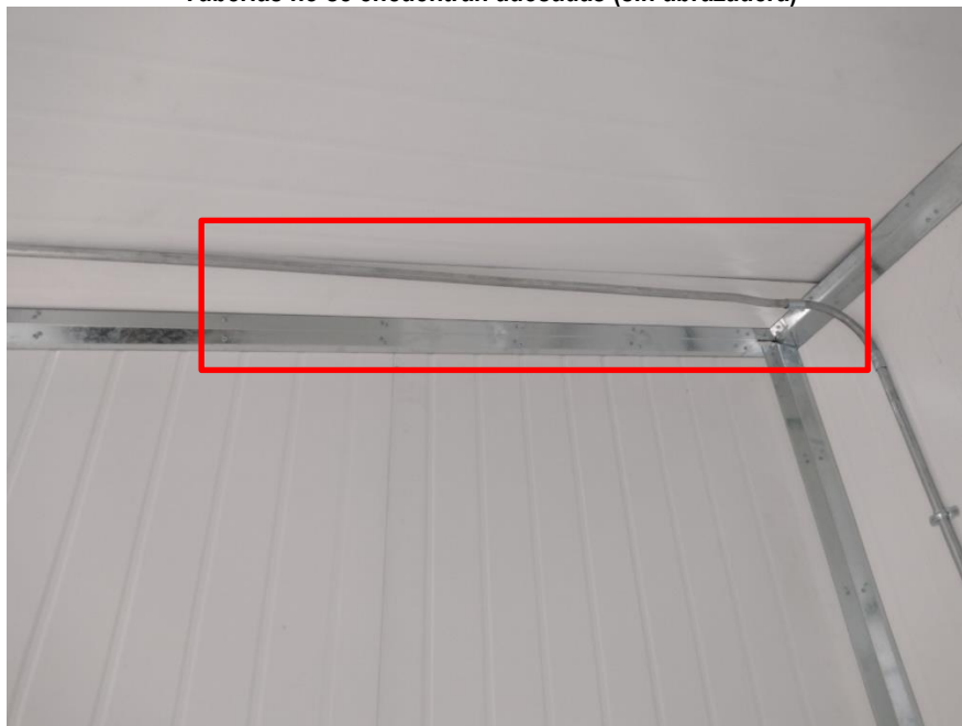
Imagen N° 28 Tuberías no se encuentran adosadas (sin abrazadera)
