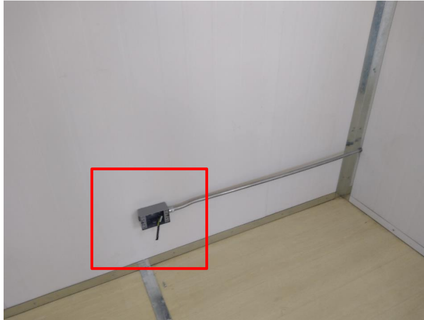
Imagen N° 27 Tomacorriente no se encuentra conectado
