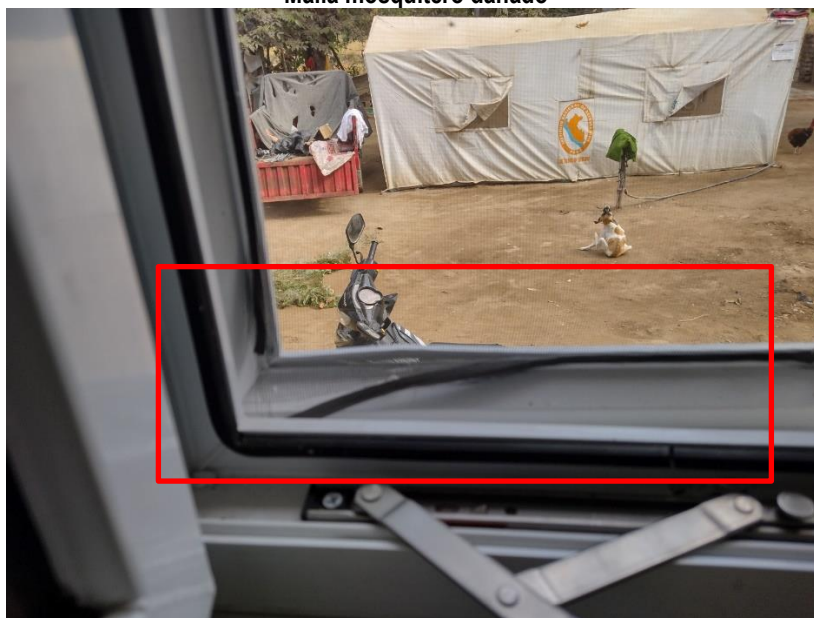
Imagen N° 9 Malla mosquitero dañado
