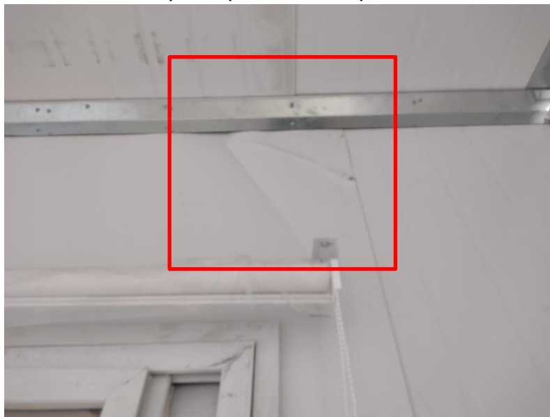
Imagen N° 22 Pared en parte superior de ventana presenta daño
