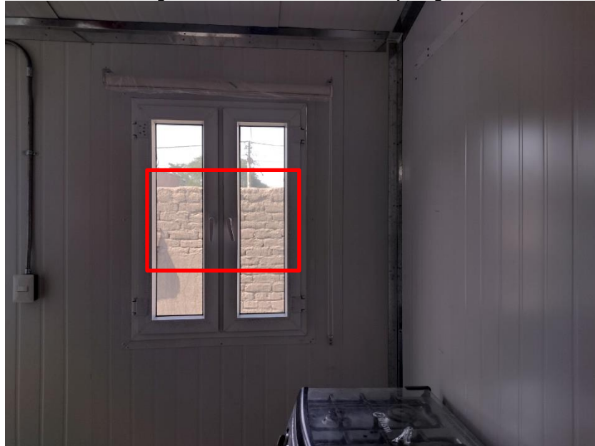
Imagen N° 7 Seguro de ventanas con dificultad para girar
