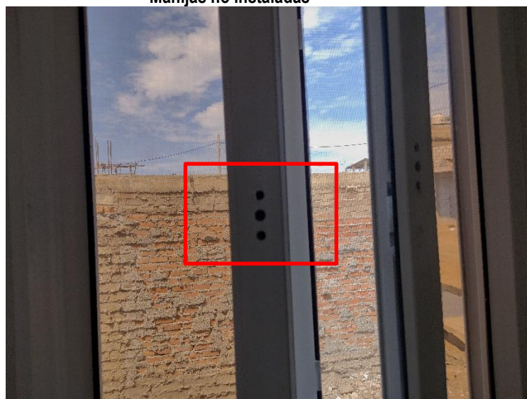
Imagen N° 6 Manijas no instaladas
