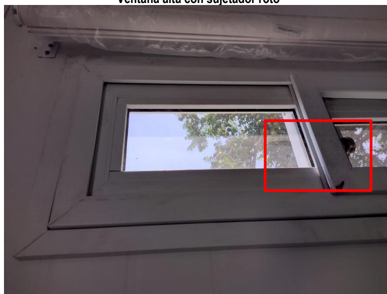
Imagen N° 10 Ventana alta con sujetador roto
